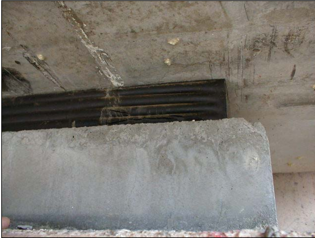
Foto 7: Detalle de un neopreno reventado uno de los apoyos del estribo de salida (Zaragoza).
