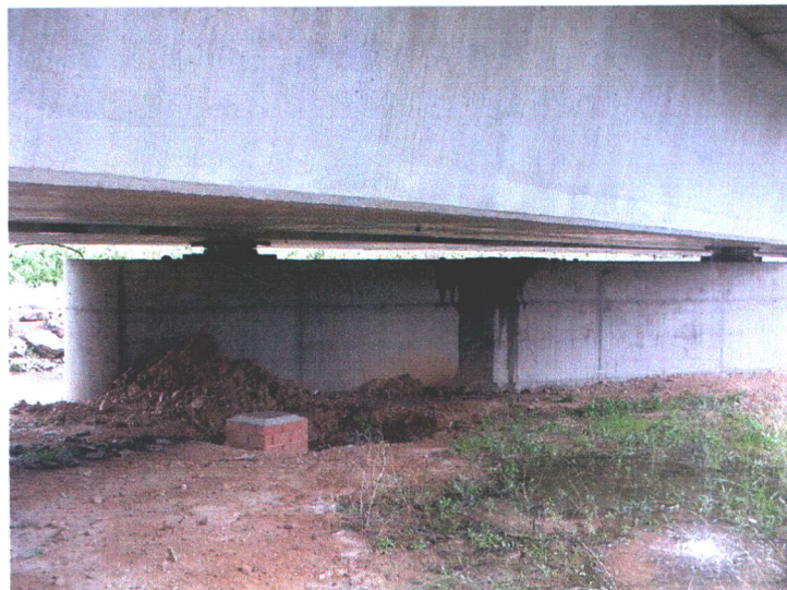
Fotografía N° 16: Humedades sobre la Pila 2.
