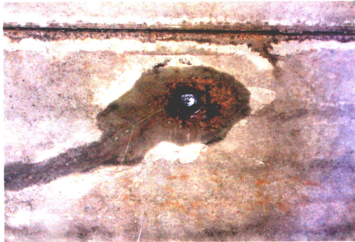
Fotografía N° 15: Vista de desagüe en el tablero, con armadura vista.
