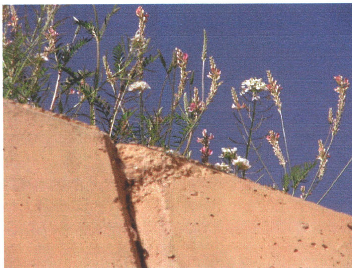
Fotografía N° 11: Golpe en aleta izquierda del es- tribo 1.
