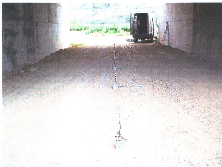
Fotografía N° 18: Detalle de los anillos extensométricos utilizados.
