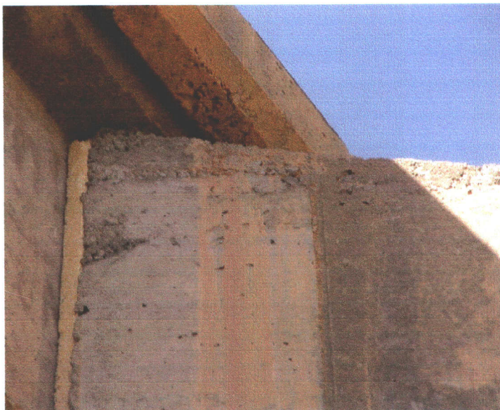
Fotografía N° 10: Nido de grava en aleta izquierda perteneciente al Estribo 1
