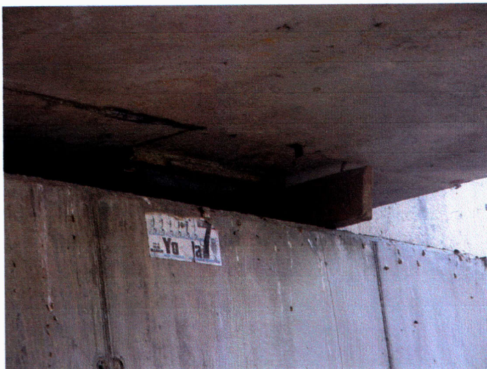
Fotografía N° 6: Fragmento de madera en el apoyo izquierdo del estribo Madrid
