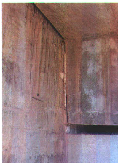
Fotografía N° 9: Humedades en el muro del estribo 1 por su unión con el tablero.
