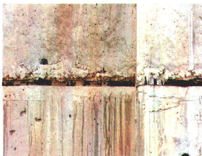
Fotografía N° 11: Nido de grava y grieta en la Pila 13.
