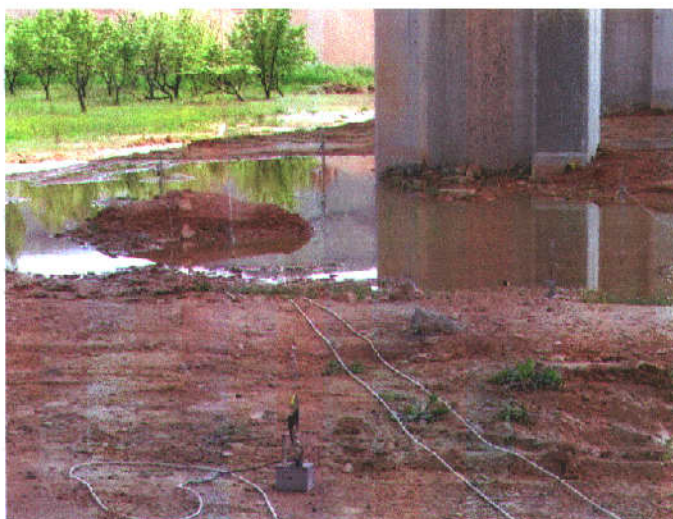
Fotografía N° 5: Instrumentación dispuesta en vano 25.
