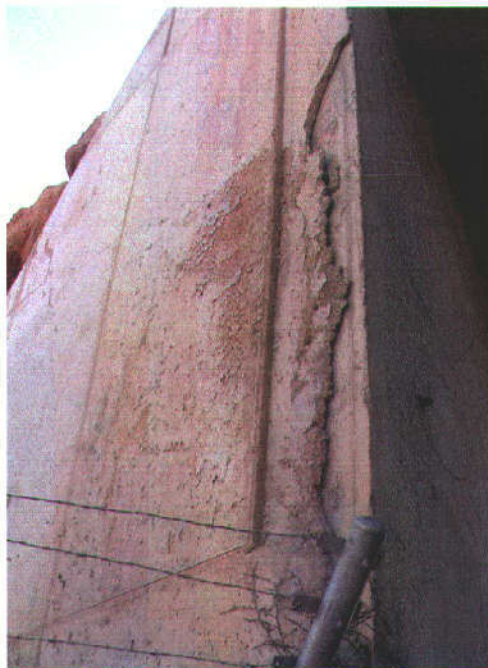
Fotografía N° 13: Desplome en la Aleta derecha del Estribo1.
