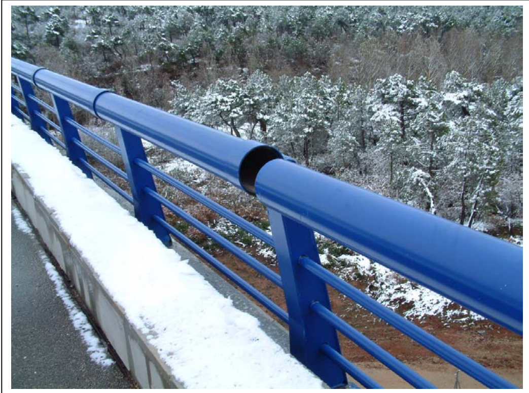
FOTOGRAFÍA N° 10: BARANDILLA DERECHA, JUNTO A ENTRADA, CON DAÑOS
