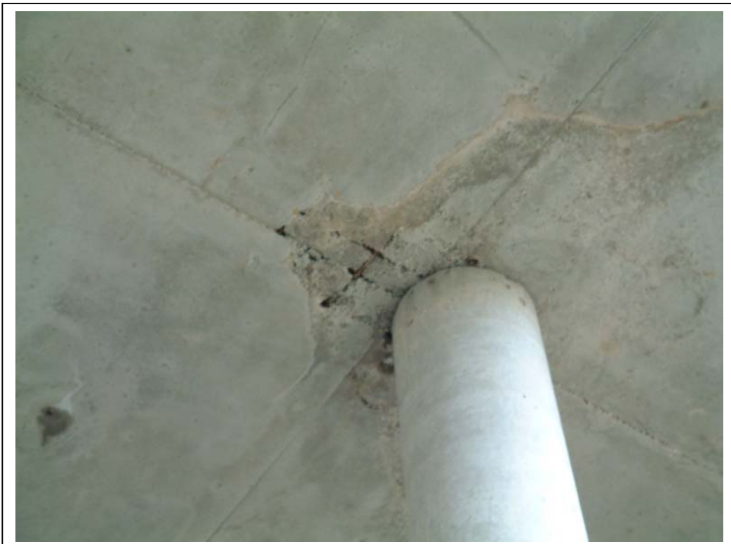
FOTOGRAFÍA Nº 10: ARMADURA VISTA EN LA CORONACIÓN DE LA PILA 11 CONTADA DESDE EL LADO IZQUIERDO
