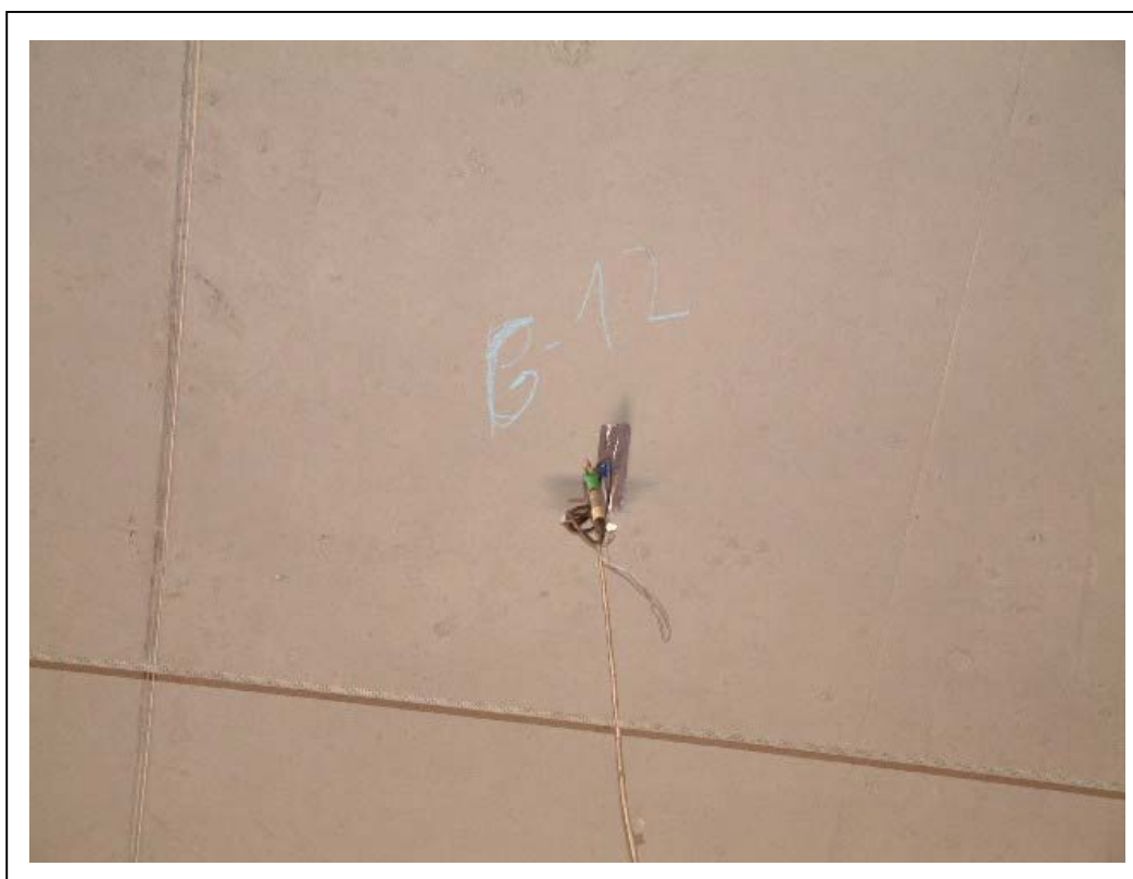
FOTOGRAFÍA 8: Galga extensométrica para la medida de deformaciones unitarias bajo el carril interior de la vía 2
