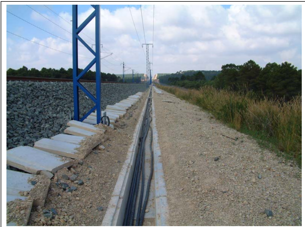
FOTOGRAFÍA Nº 10: CANALIZACIÓN PARA CABLEADO JUNTO A VÍA IZQUIERDA
