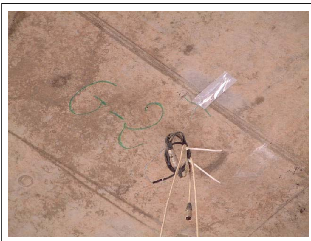
FOTOGRAFÍA 6: Banda extensométrica colocada bajo el carril interior de la vía izquierda
