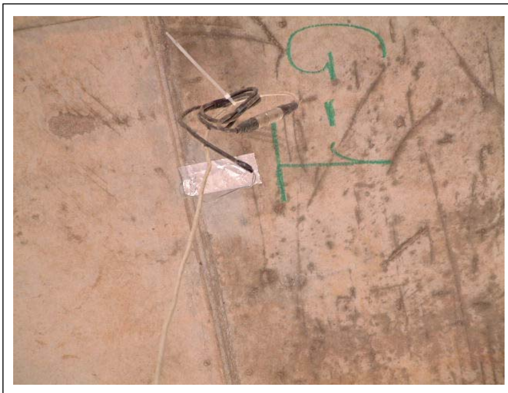
FOTOGRAFÍA 5: Banda extensométrica colocada bajo el carril interior de la vía derecha
