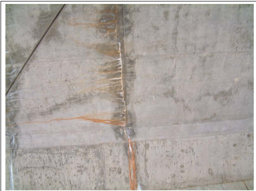
FOTOGRAFÍA N° 10: FISURA A LA ALTURA DEL 7º MÓDULO COMPLETO. PROGRESIÓN EN TODA LA LONGITUD DEL TABLERO. AQUÍ SE APRECIA LA PARTE DE LA FISURA MÁS PRÓXIMA AL HASTIAL MADRID
