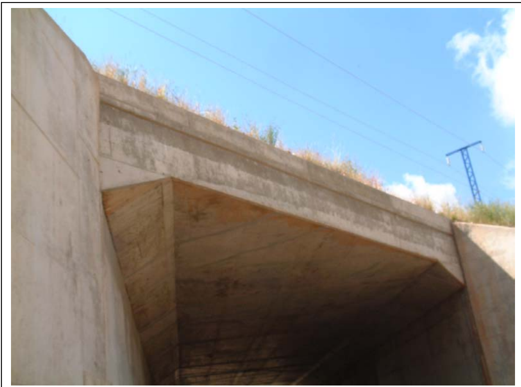
FOTOGRAFÍA N° 2: VISTA LATERAL IZQUIERDA DEL TABLERO
