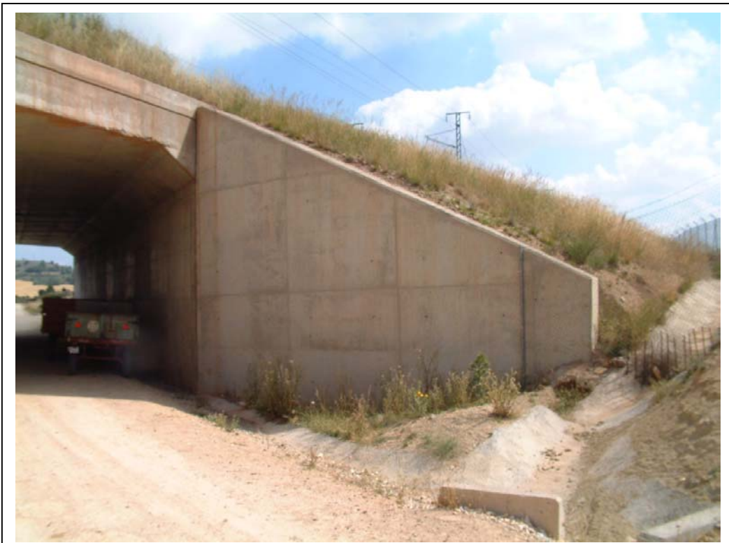
FOTOGRAFÍA Nº 6: ALETA DERECHA DEL ESTRIBO ZARAGOZA
