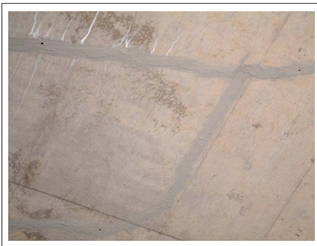
FOTOGRAFÍA 2: Fisuras reparadas en zona inferior de tablero
