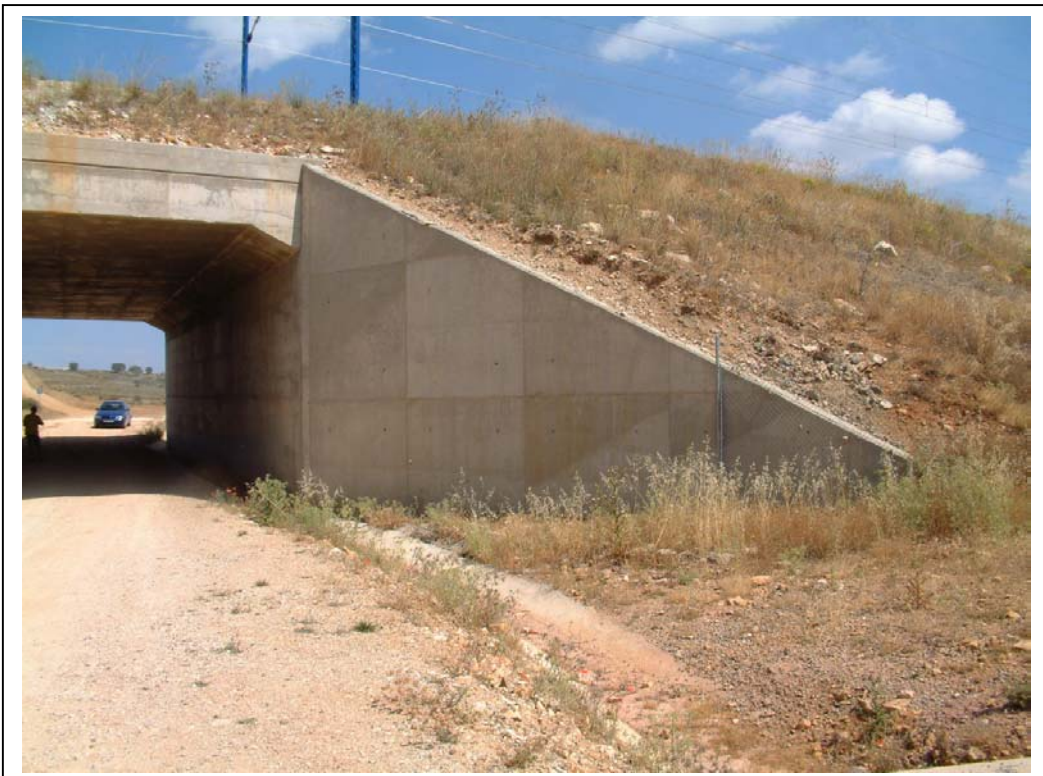
FOTOGRAFÍA Nº 4: ALETA DERECHA DEL ESTRIBO ZARAGOZA
