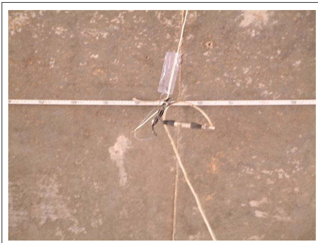
FOTOGRAFÍA 5: Galga extensométrica en la sección central del Paso Inferior
