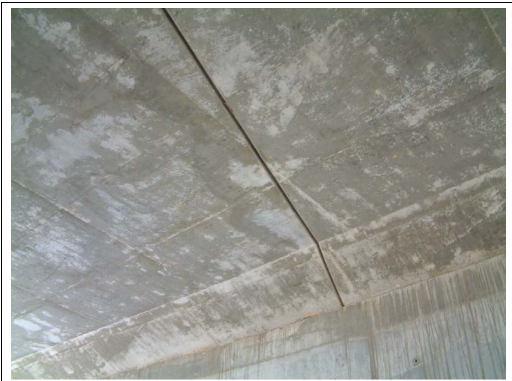
FOTOGRAFÍA N° 8: JUNTA LONGITUDINAL EN TABLERO
