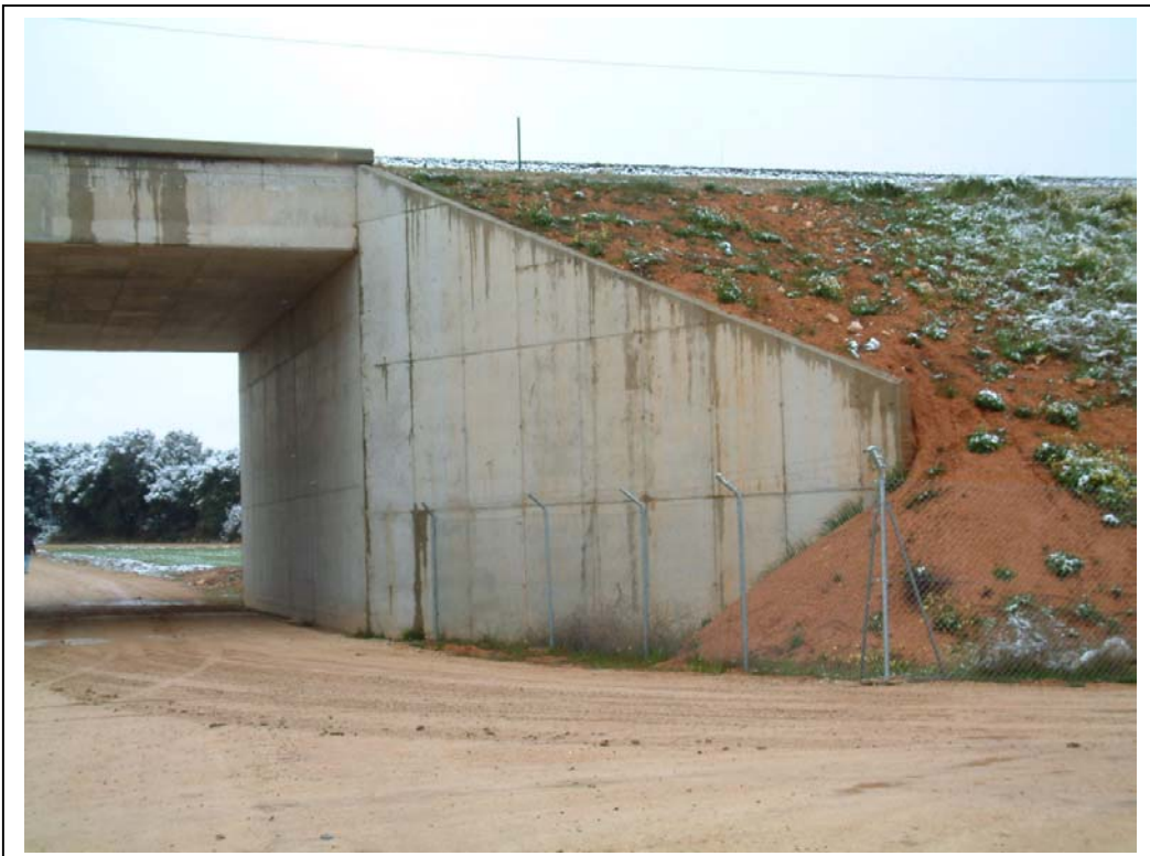
FOTOGRAFÍA Nº 4: ALETA DERECHA DE ESTRIBO ZARAGOZA
