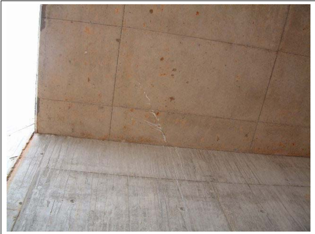
FOTOGRAFÍA N° 10: FISURA CON CARBONATACIÓN EN 2º MÓDULO ENTERO DE HORMIGONADO DEL TABLERO JUNTO AL ESTRIBO MADRID
