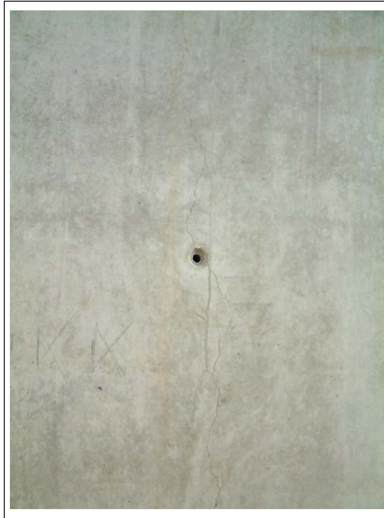
FOTOGRAFÍA N° 7: FISURA VERTICAL EN PARAMENTO DE ESTRIBO
