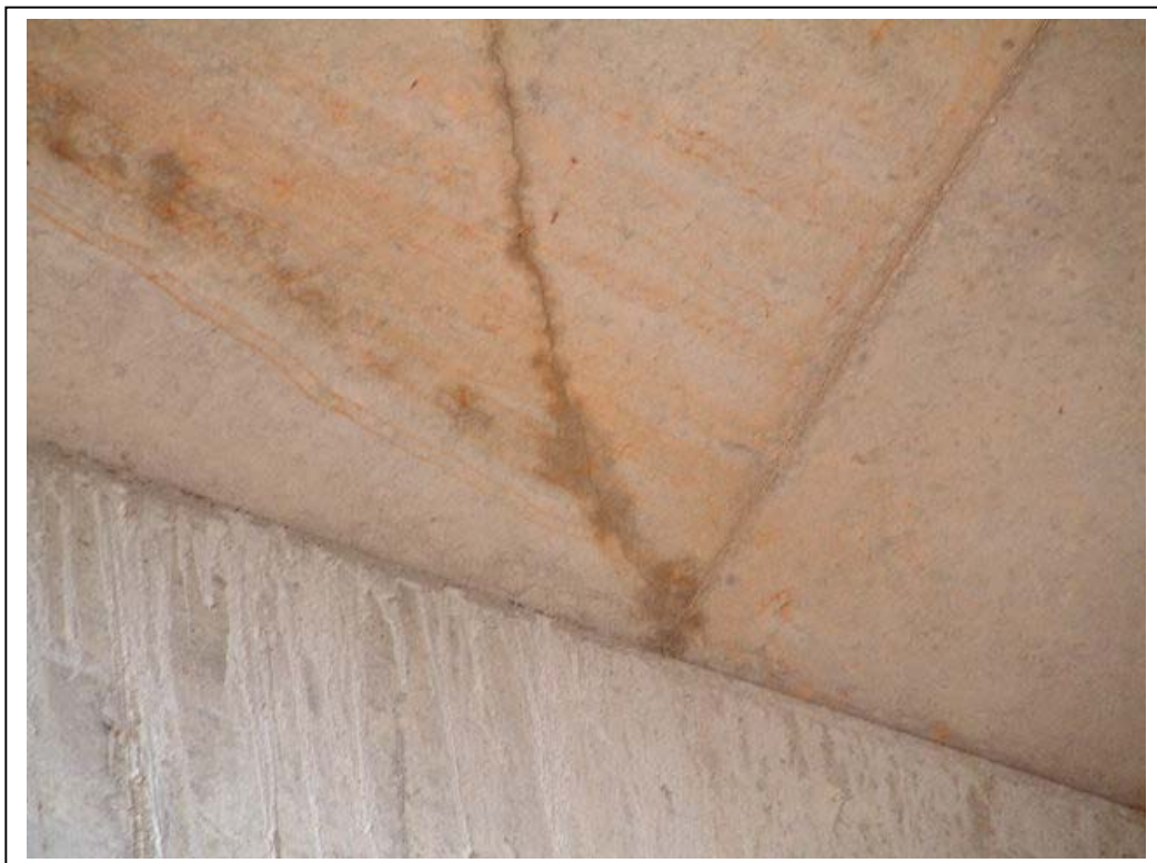
FOTOGRAFÍA N° 8: FISURA EN BORDE IZQUIERDO DE TABLERO JUNTO AL ESTRIBO ZARAGOZA
