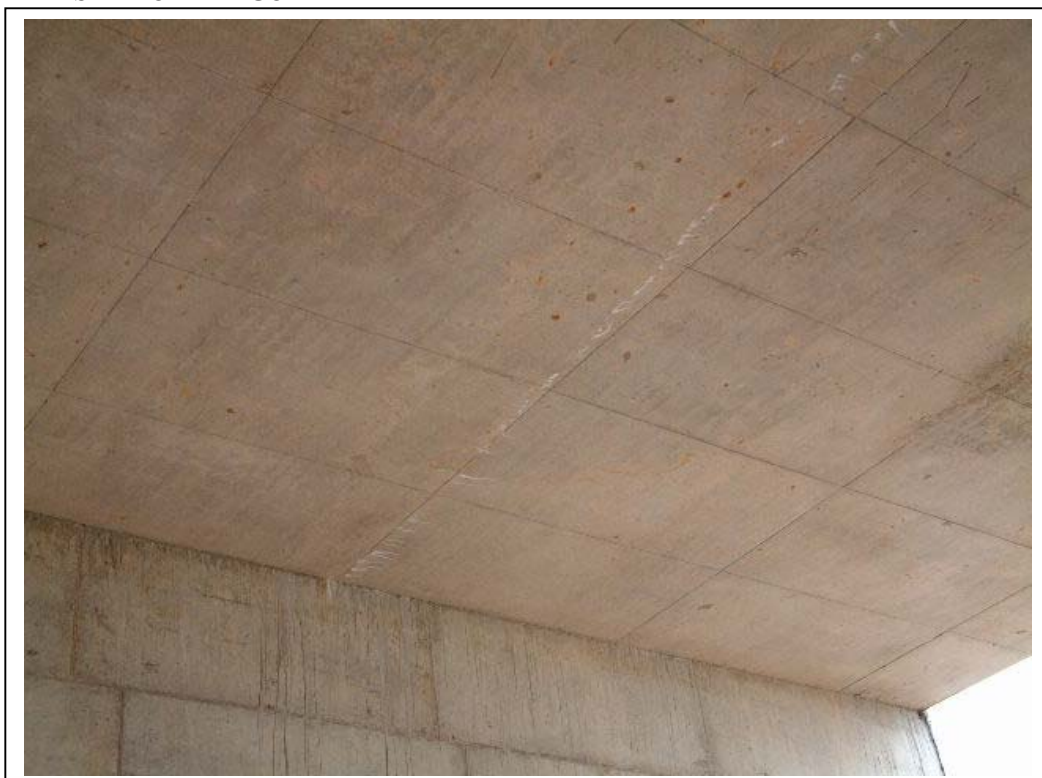
FOTOGRAFÍA N° 9: GRIETA LONGITUDINAL BAJO VÍA DERECHA CON CARBONATACIÓN
