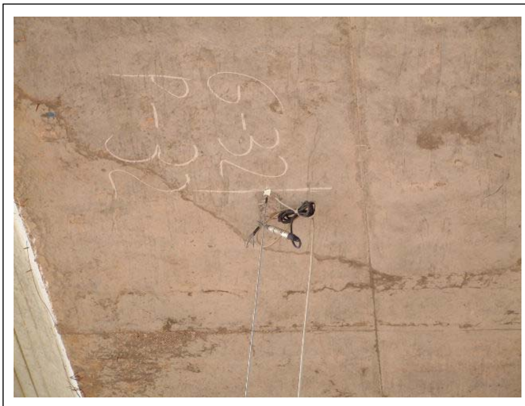
FOTOGRAFÍA 7: Galgas y flechas a 0,45 L en vano 3 (puntos G-32 y P-32, respectivamente)
