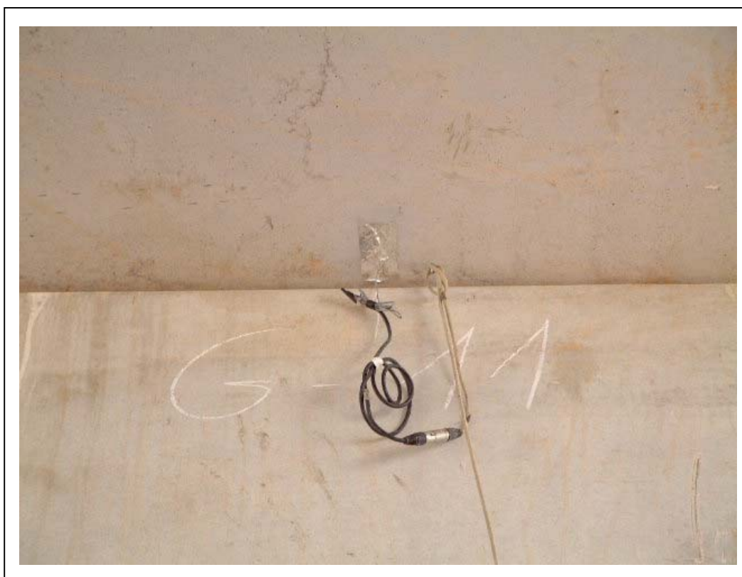
FOTOGRAFÍA 8: Galga extensométrica junto al estribo Zaragoza bajo la vía derecha
