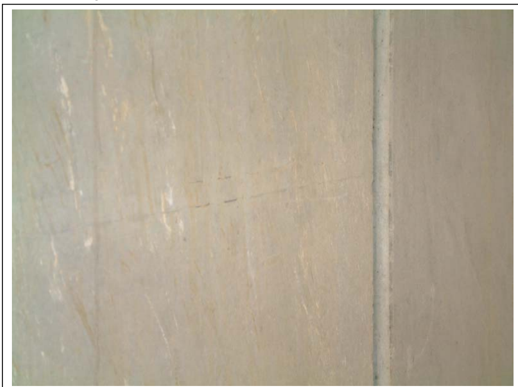
FOTOGRAFÍA N° 8: FISURAS HORIZONTALES EN PARAMENTOS VERTICALES DE ESTRIBO MADRID
