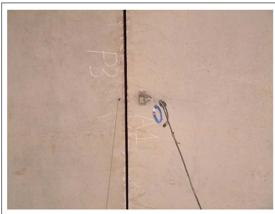
FOTOGRAFÍA 8: Acelerómetro para la medida de la frecuencia fundamental de vibración de la estructura junto al punto P-3
