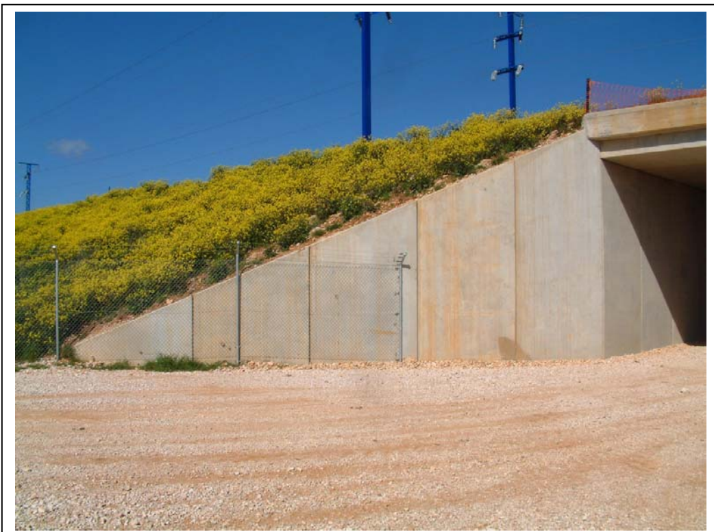
FOTOGRAFÍA Nº 4: VISTA DE ALETA DERECHA DE ESTRIBO MADRID
