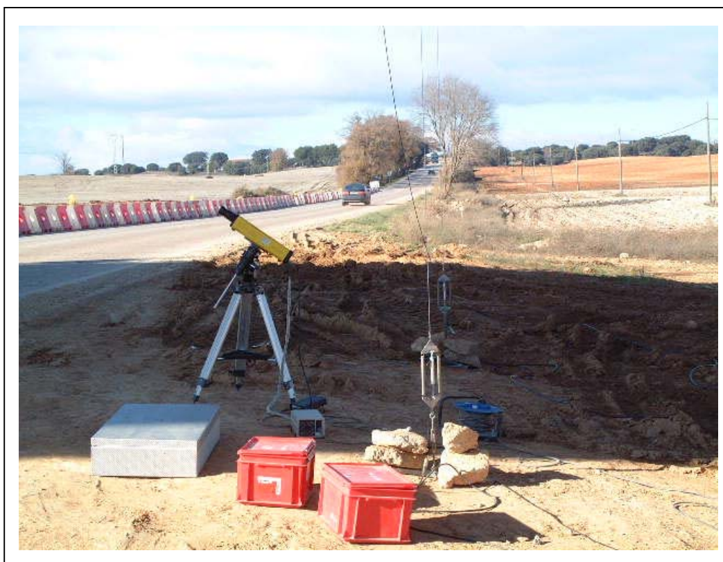
FOTOGRAFÍA 6: Aparato láser para la medida de flechas en el vano 2
