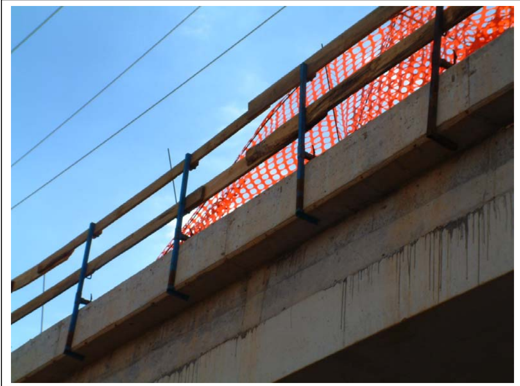
FOTOGRAFÍA Nº 9: BARANDILLAS PROVISIONALES EN TABLERO
