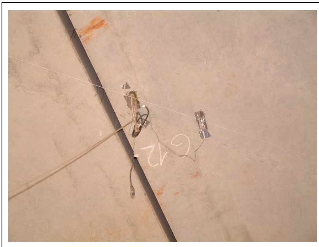
FOTOGRAFÍA 7: Punto G-12 para la medida de deformaciones unitarias colocado bajo el carril interior de la vía 2
