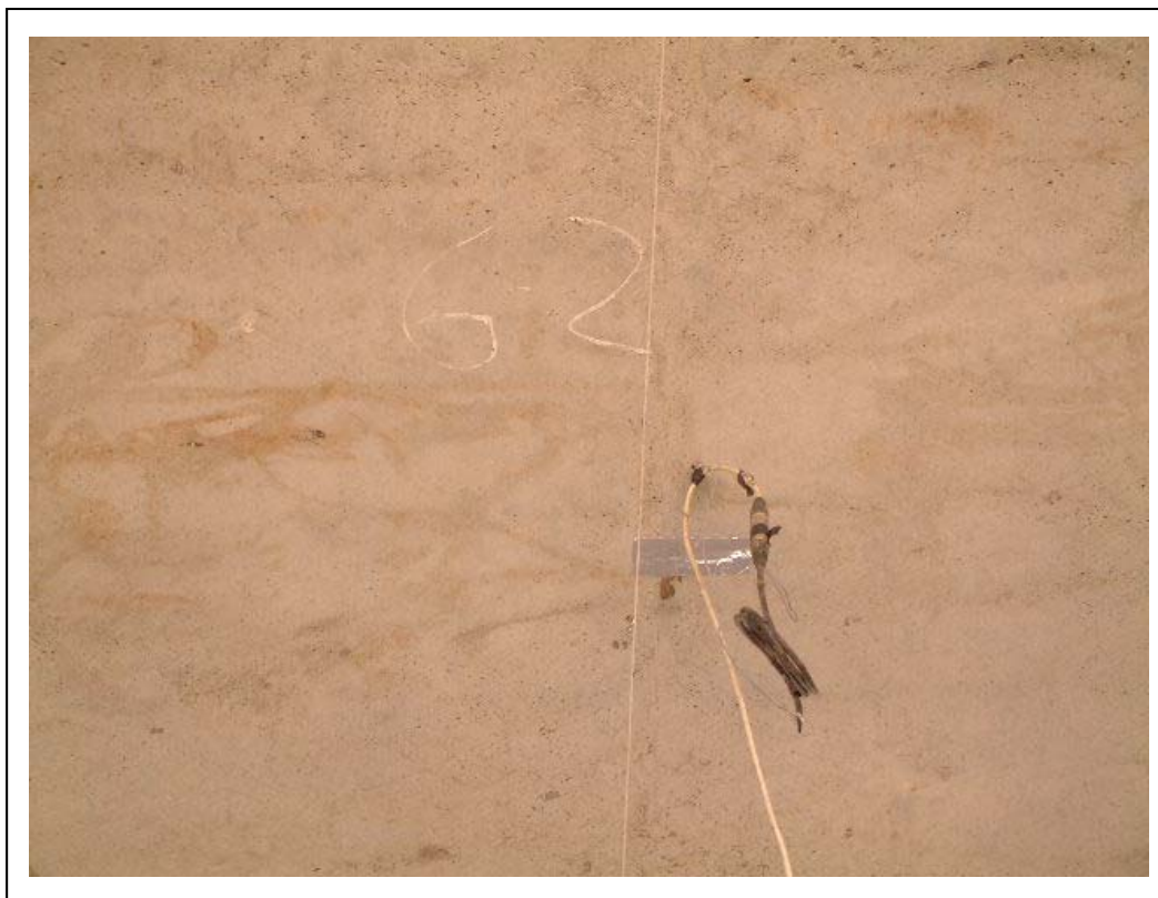
FOTOGRAFÍA 7: Galga para medida de deformaciones unitarias en el carril interior de la vía 2
