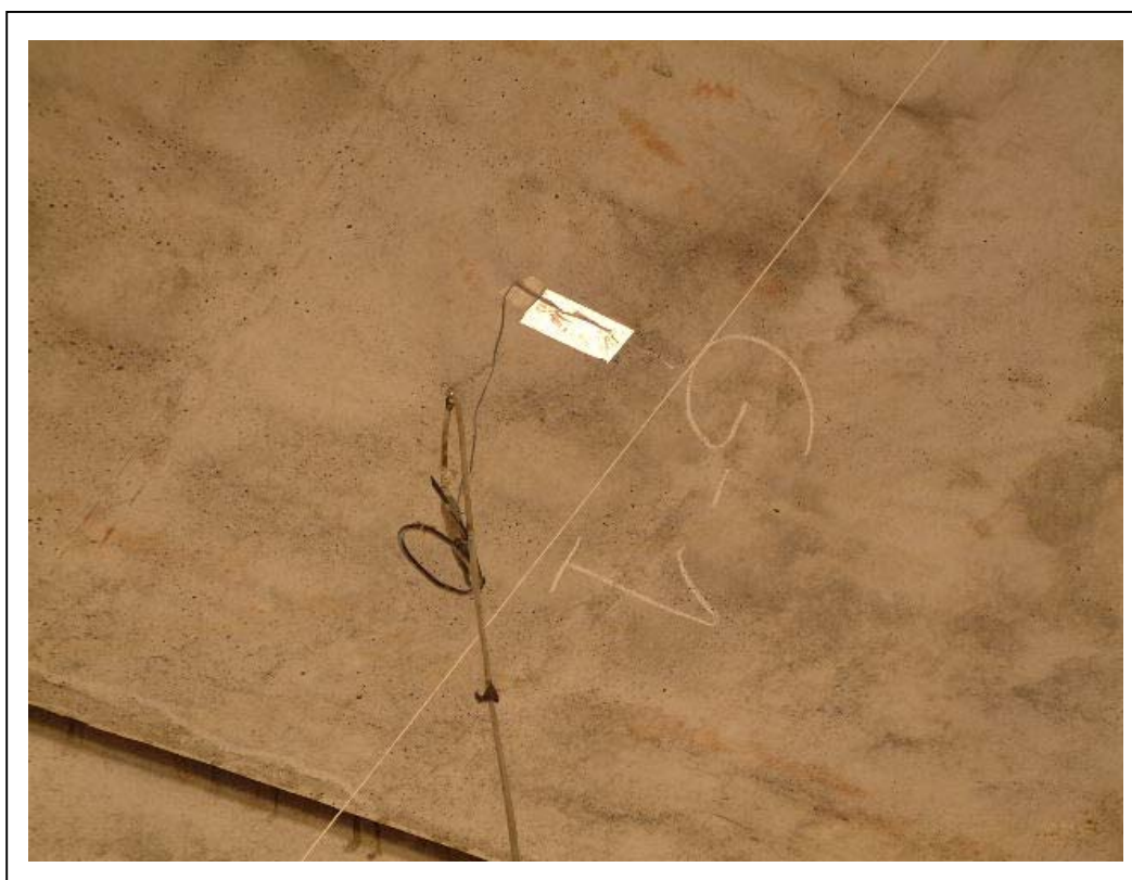
FOTOGRAFÍA 6: Galga para medida de deformaciones unitarias en el carril interior de la vía 1
