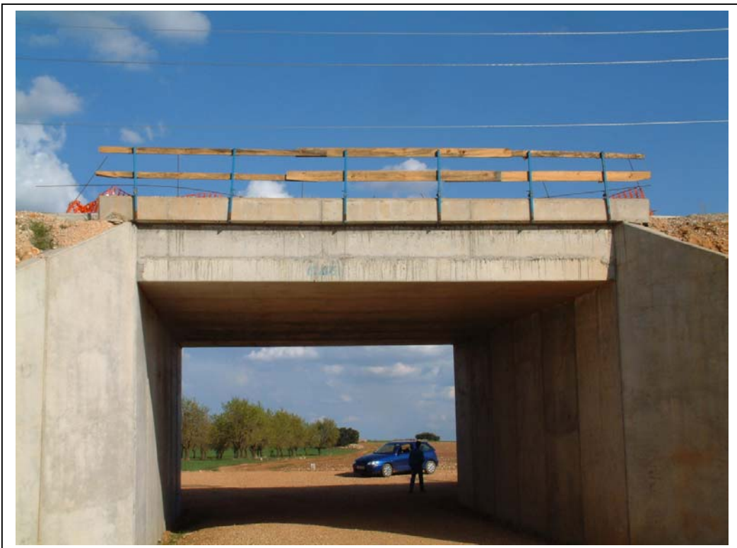
FOTOGRAFÍA Nº 6: VISTA DE TABLERO
