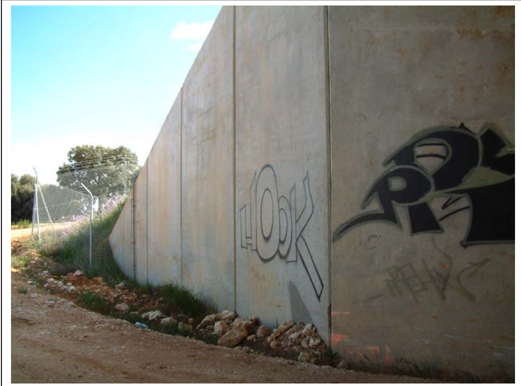
FOTOGRAFÍA Nº 3: VISTA DE ALETA DERECHA DE ESTRIBO MADRID
