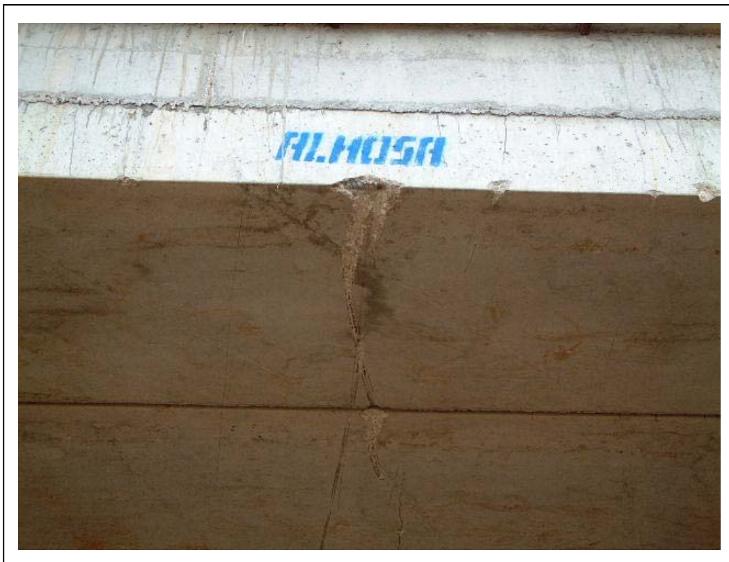
FOTOGRAFÍA 2: Armadura vista en el centro del vano y fisura debida a algún golpe posterior a la inspección preliminar
