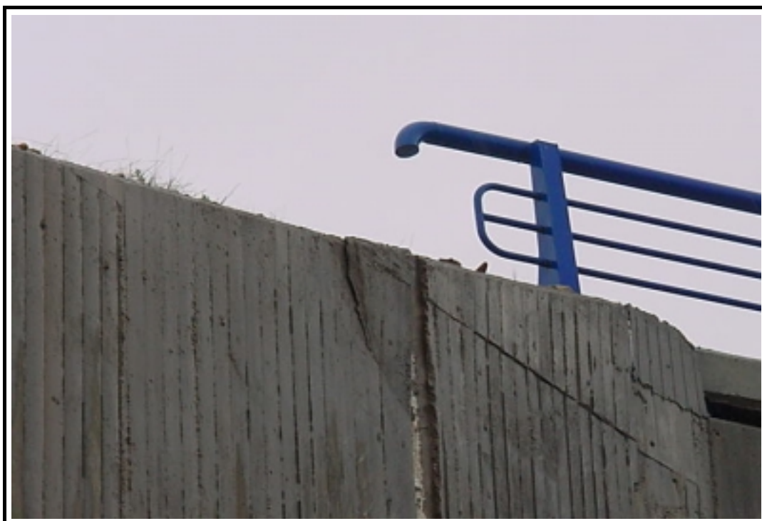
Foto 8: Rotura en aleta 4. Estribo de Salida
