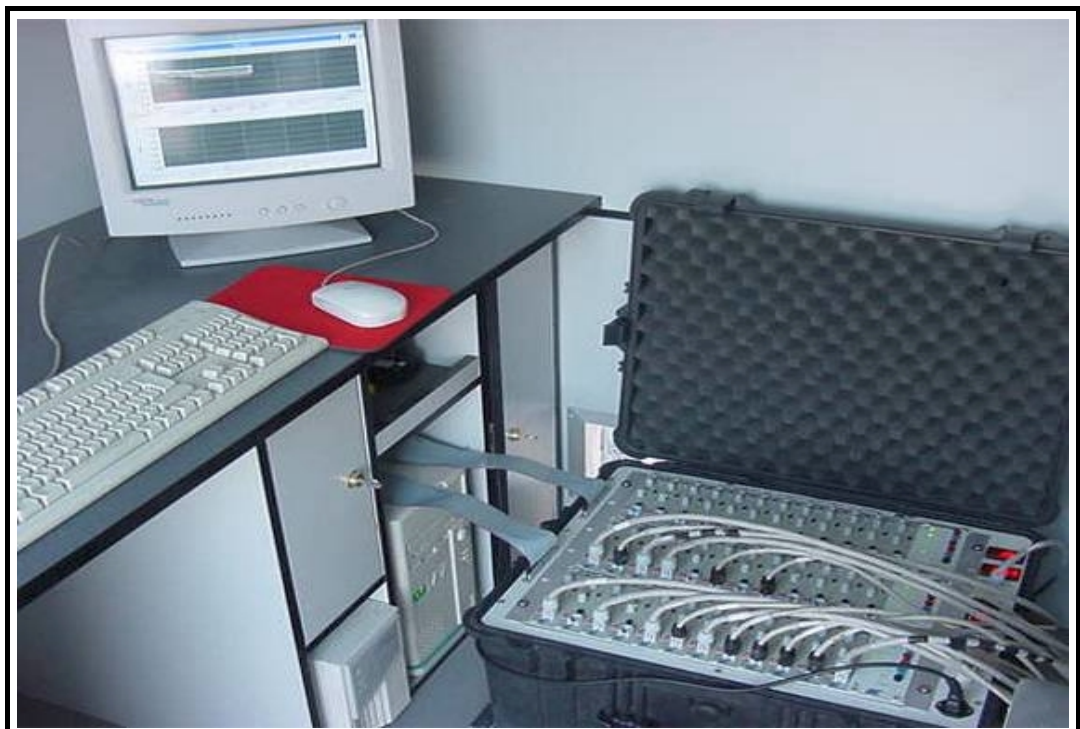
Foto 7: Vista general de acondicionadores de señal y equipo de adquisición
