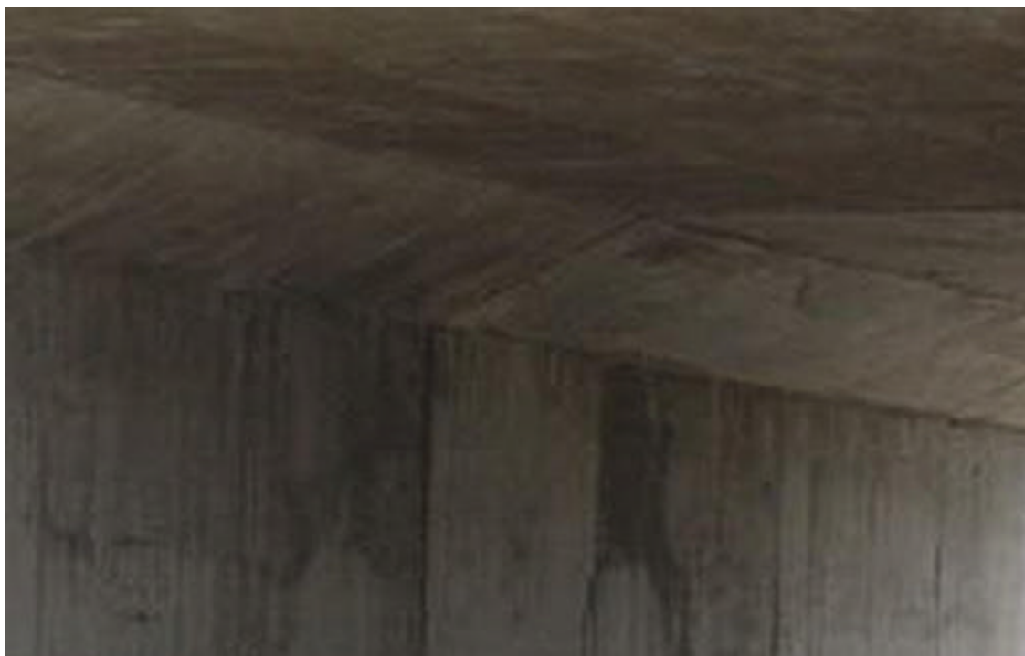
Foto6:Detalle de junta longitudinal
