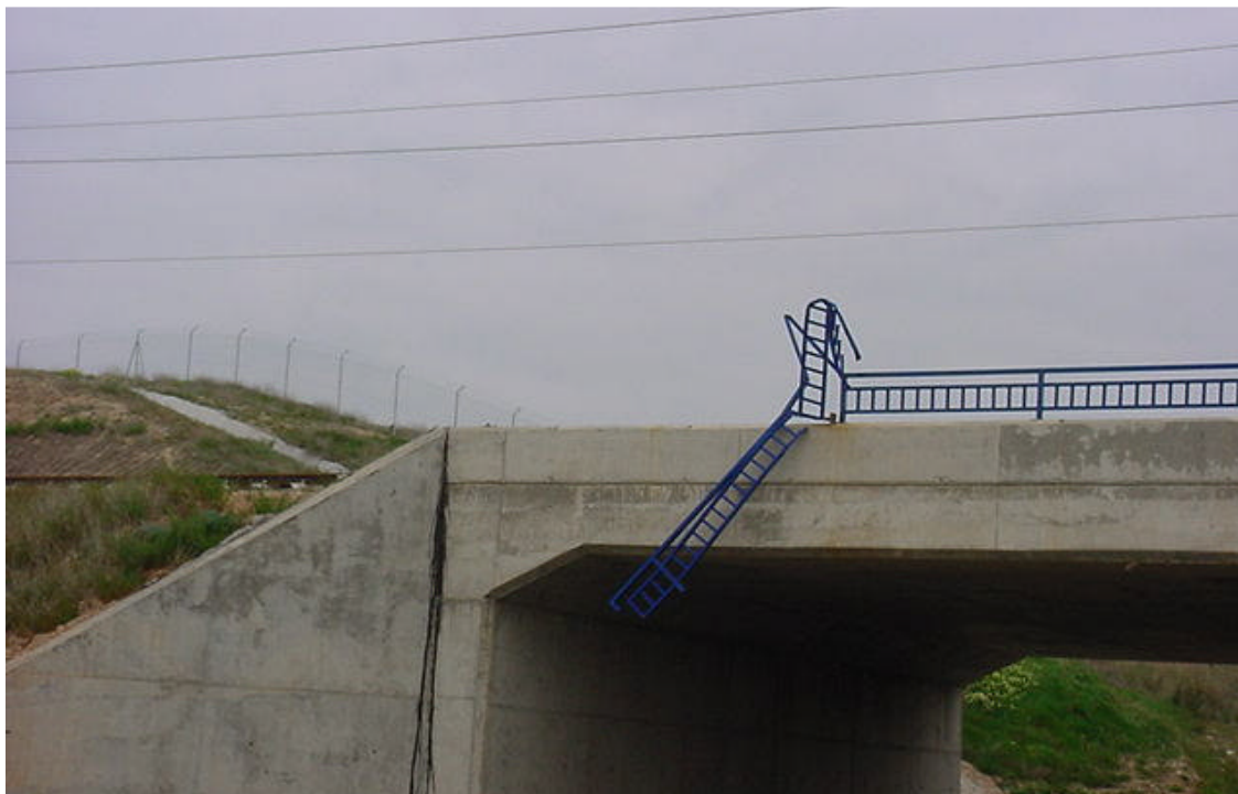
Foto9: Rotura de barandilla en alzado derecho
