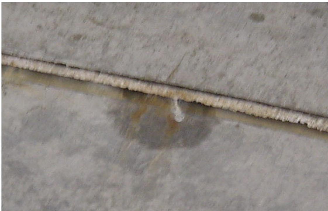
Foto10: Humedad y degradación de junta longitudinal
