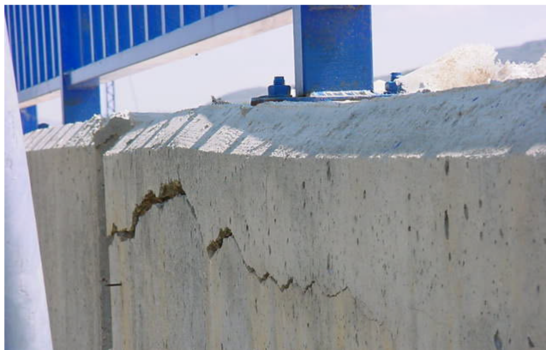
Foto10:Rotura en muro de acompañamiento (vista inferior)
