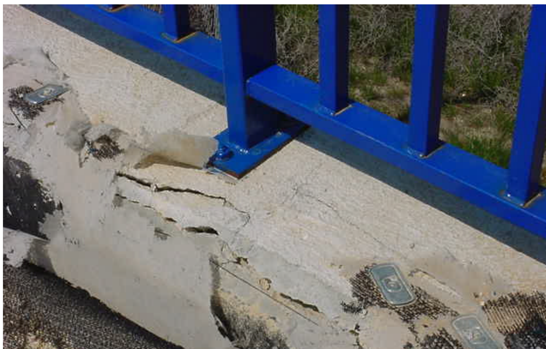
Foto11: Rotura en muro de acompañamiento (vista superior)
