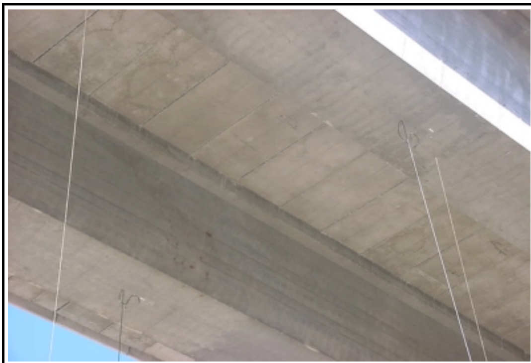
Foto 7: Ménsulas para la medida de desplazamientos
