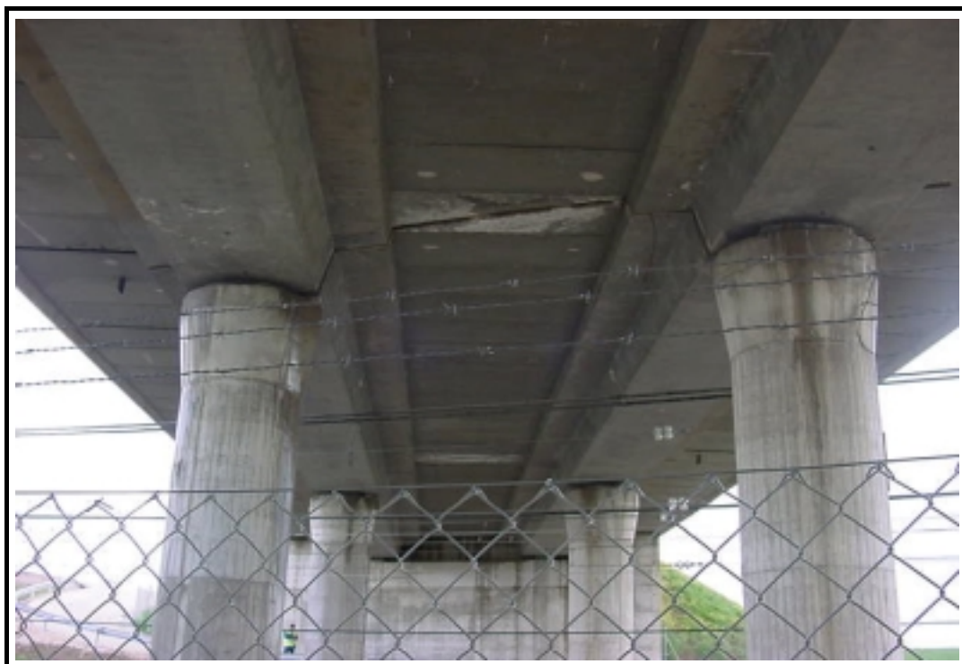
Foto 8: Rotura en estribo de salida
