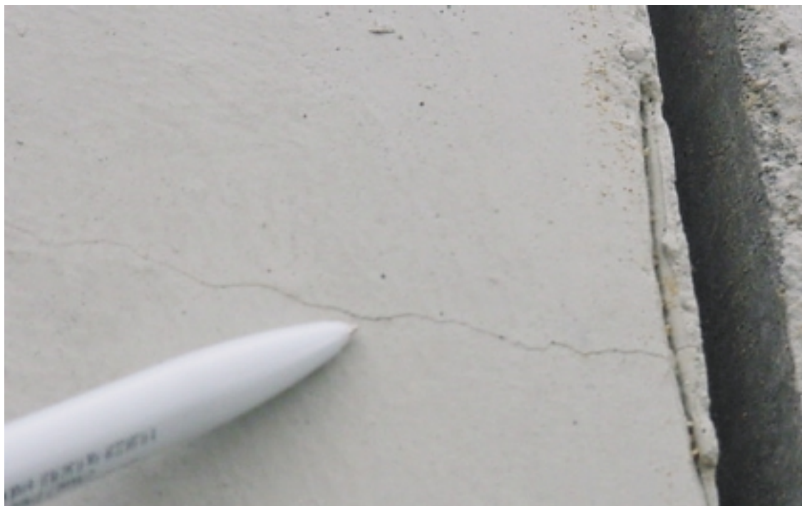
Foto 10: Fisuración en aletas.
