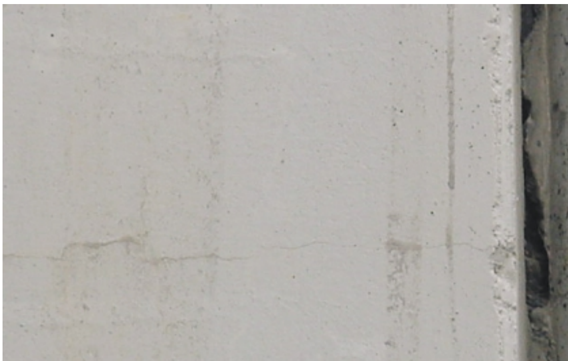
Foto 9: Fisuración en estribos.
