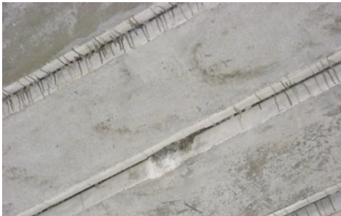
Foto 8: Golpe en estructura de tramos.
