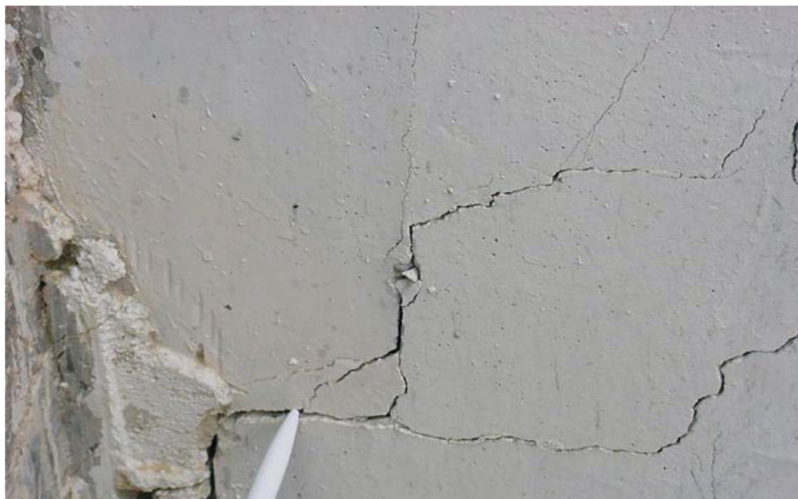
Foto 9: Fisuración en muro de acompañamiento en alzado derecho.
