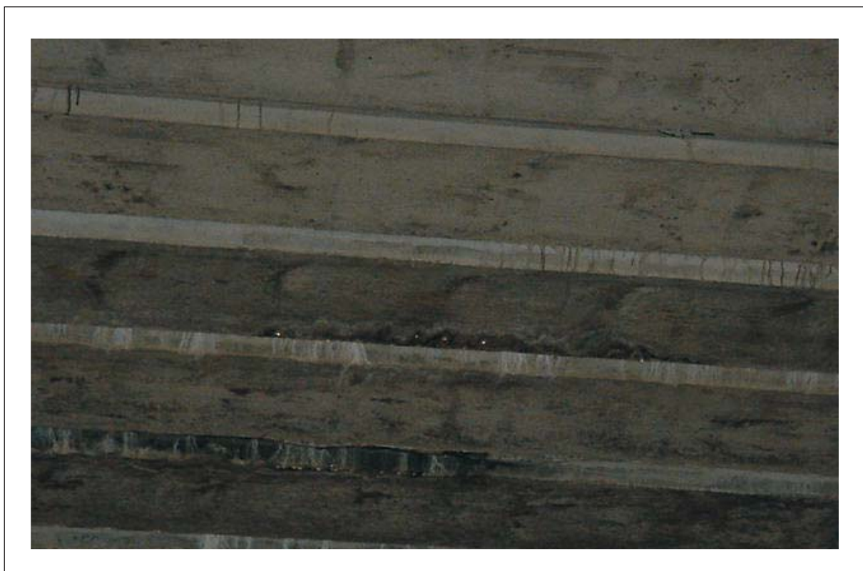
Foto 8: Humedades en estructura de tramos.
