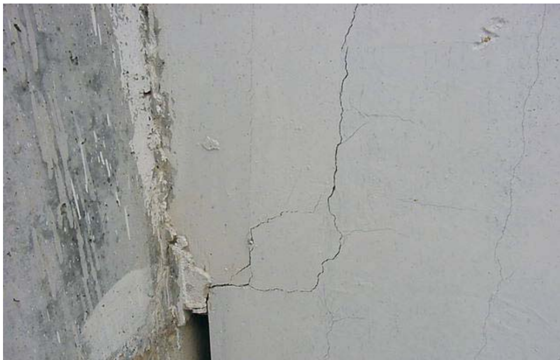
Foto 10: Fisuración en muro de acompañamiento en alzado derecho.
