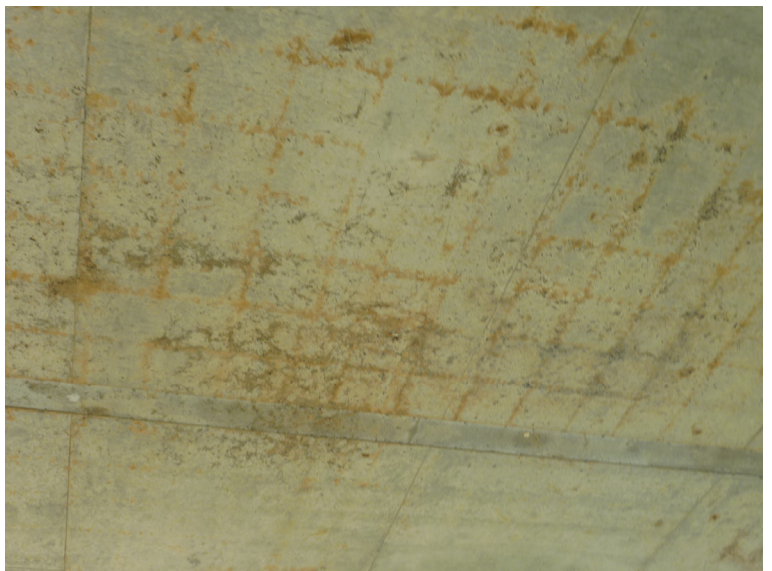
Fotografía N°11: Nido de grava en vano 3.
