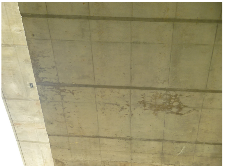
Fotografía N°15: Nido de grava en vano 2.
