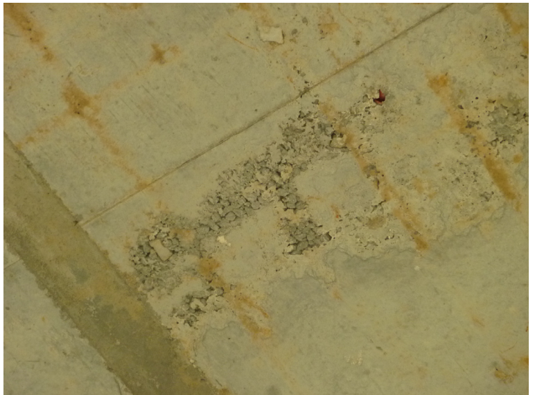
Fotografía N°10: Nido de grava en vano 3.
