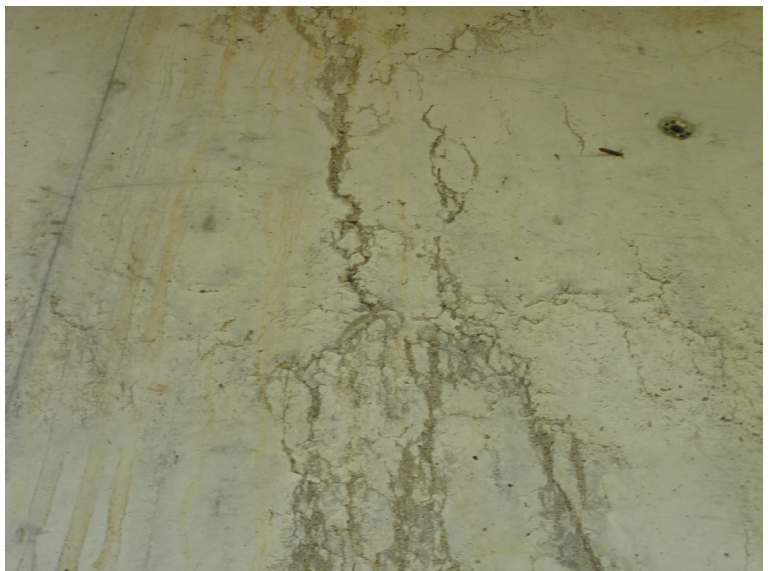
Fotografía N°14: Nido de grava en muro de estribo 2.
