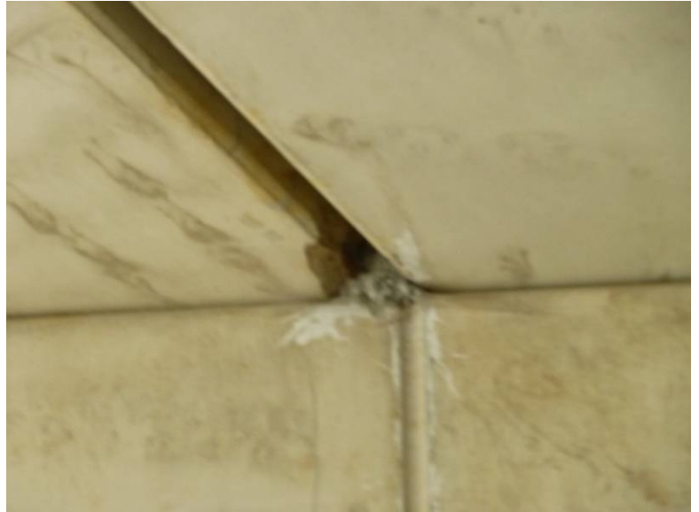
Fotografía N°13: Desconchón en la prelosa.
