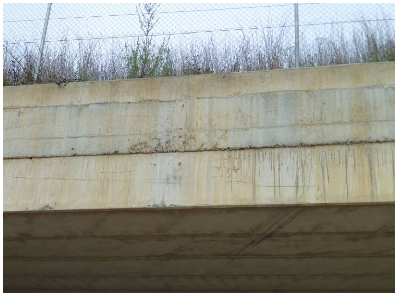
Fotografía N°12: Nido de grava en el lado derecho de la losa.
