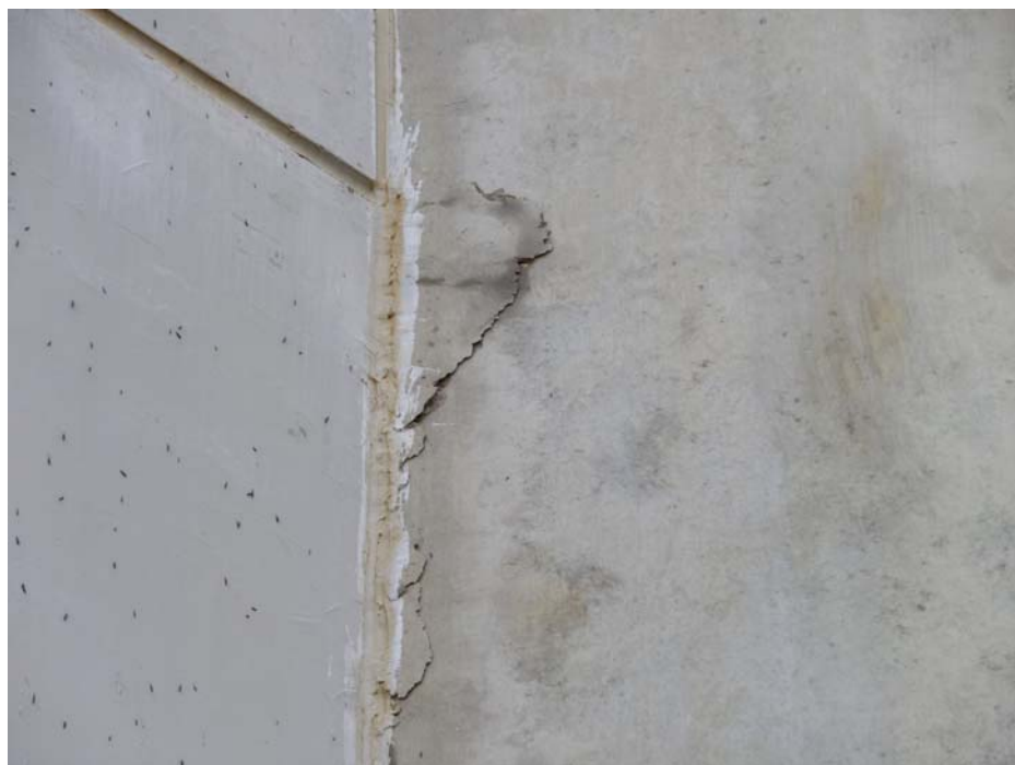
FOTOGRAFIA N° 13: Desprendimiento de hormigón en la aleta izquierda de E-1
