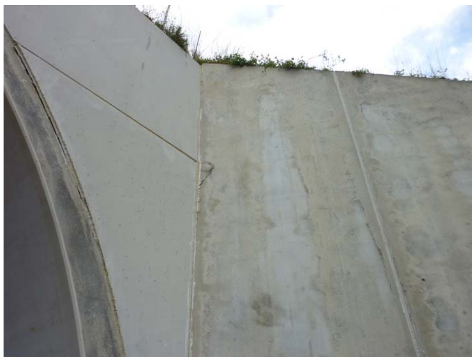
FOTOGRAFIA N° 12: Desprendimiento de hormigón en la aleta izquierda de E-1
