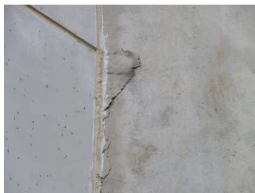
Fotografía nº 8. Desprendimiento de hormigón en la aleta izquierda del estribo de entrada
