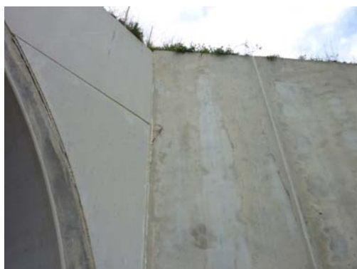
Fotografía nº 7. Desprendimiento de hormigón en la aleta izquierda del estribo de entrada
