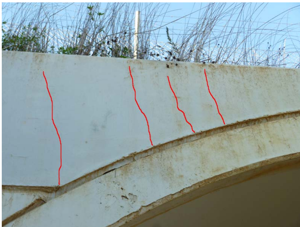
Fotografía nº 7. Fisuras en el tímpano. Alzado derecho
