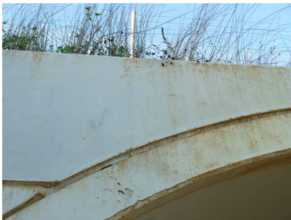
FOTOGRAFIA N° 12: Fisuras en el tímpano. Alzado derecho
