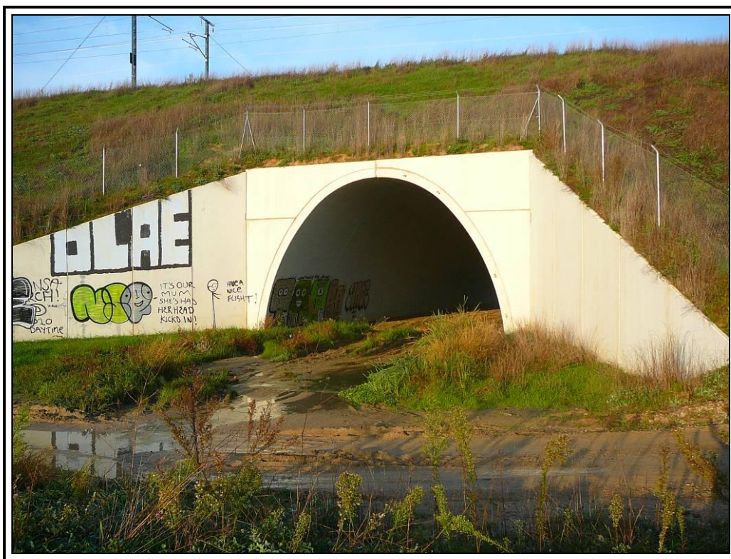
Acumulación de materiales de arrastre y vegetación en embocadura derecha
