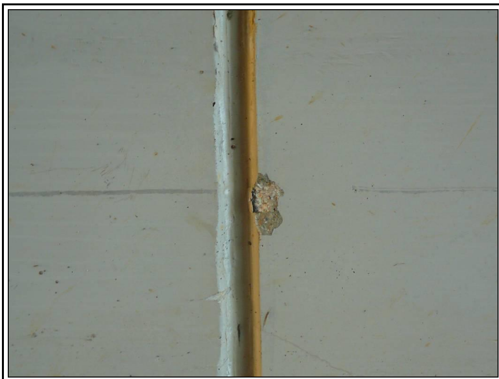
Desconchón en semibóveda de entrada cerca embocadura izquierda
