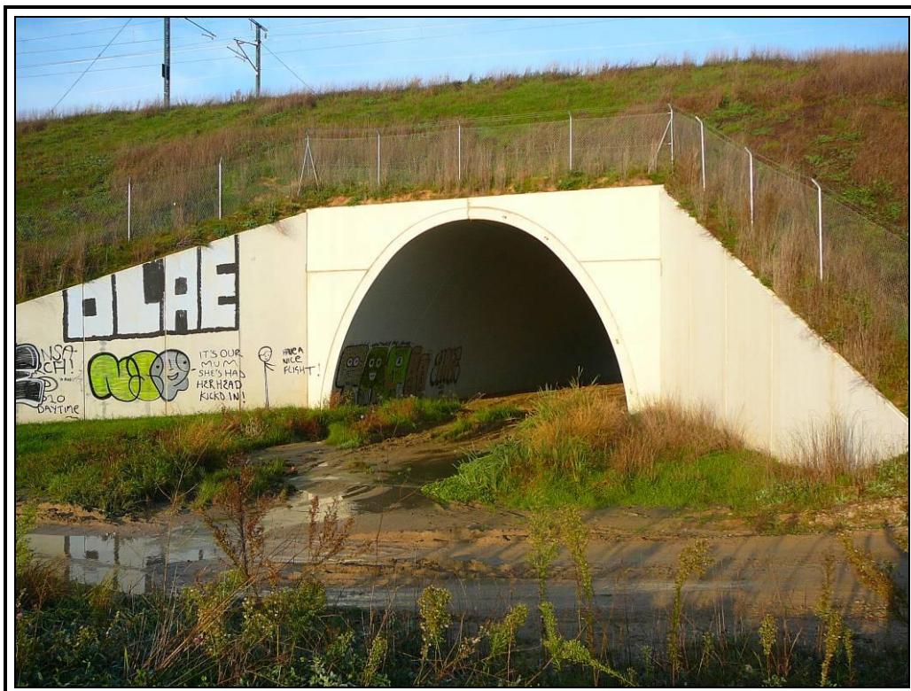
Acumulación de materiales de arrastre y vegetación en embocadura derecha
