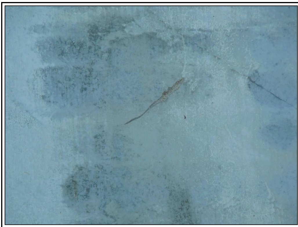
Desconchón en aleta izquierda de semibóveda de entrada
