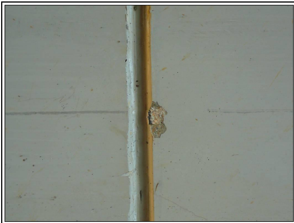
Desconchón en semibóveda de entrada cerca embocadura izquierda
