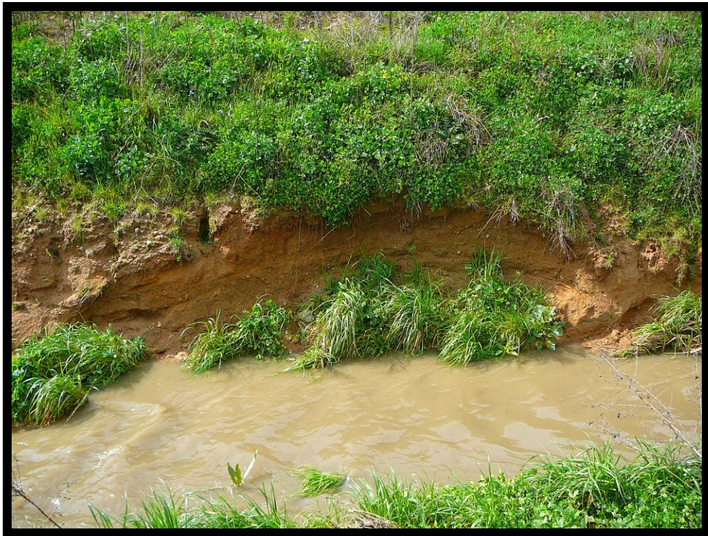
23. Socavación en margen izquierda, aguas abajo.
