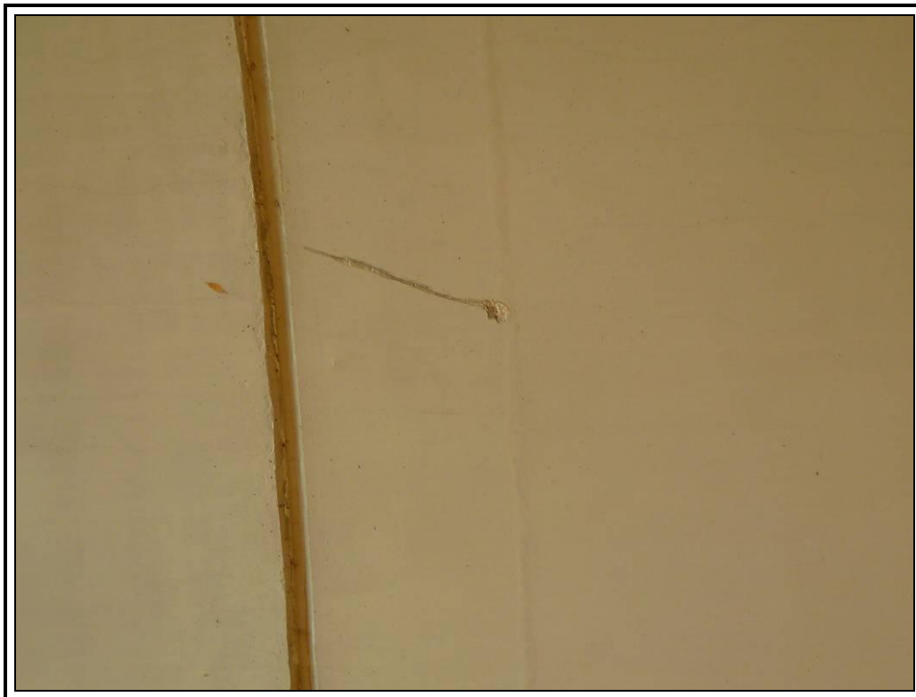
Desconchón en semibóveda de entrada cerca embocadura derecha
