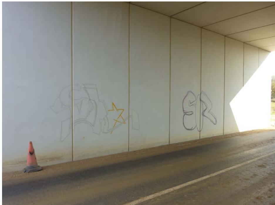
FOTOGRAFIA N° 12: Pintadas en el hastial del estribo de salida
