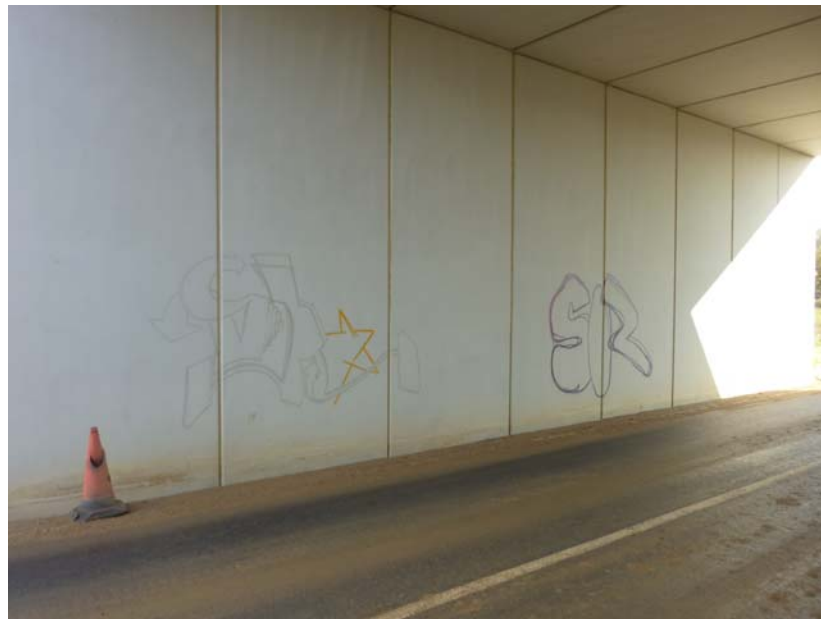
Fotografía nº 7. Pintadas en el hastial del estribo de salida
