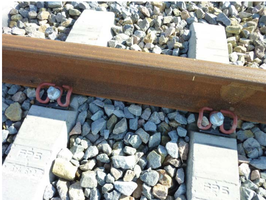
FOTOGRAFIA N° 7: Detalle de sujeción del carril
