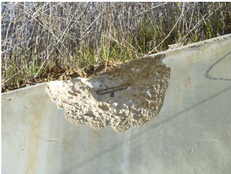
FOTOGRAFIA N° 15: Desconchón con armadura expuesta en la aleta izquierda de E-2
