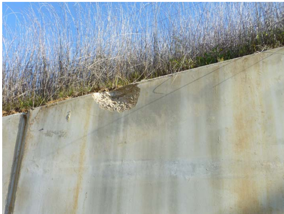
FOTOGRAFIA N° 14: Desconchón con armadura expuesta en la aleta izquierda de E-2
