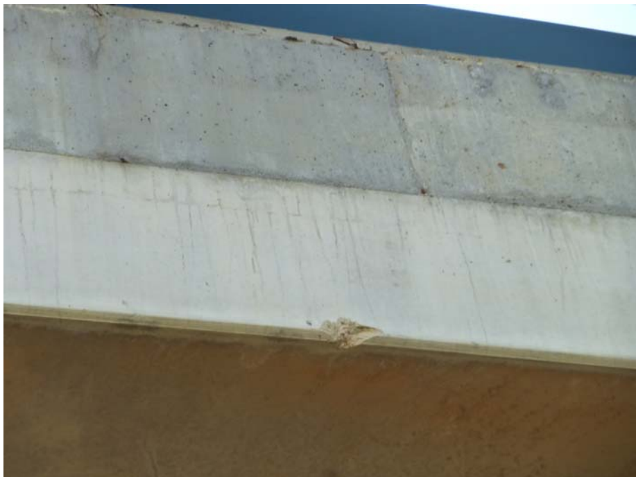
FOTOGRAFIA N° 16: Desconchón en la losa superior (Embocadura izquierda)
