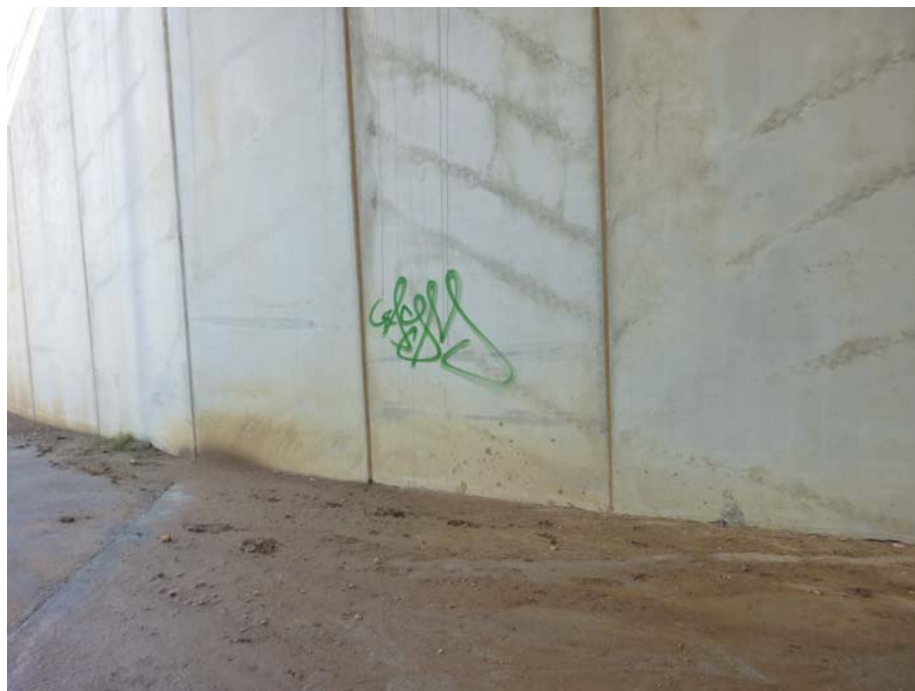
FOTOGRAFIA N° 13: Pintadas en el hastial del estribo de salida
