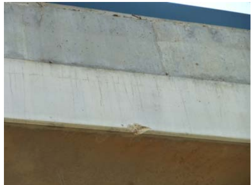
Fotografía nº 8. Desconchón en el canto de la losa superior. Embocadura izquierda.
