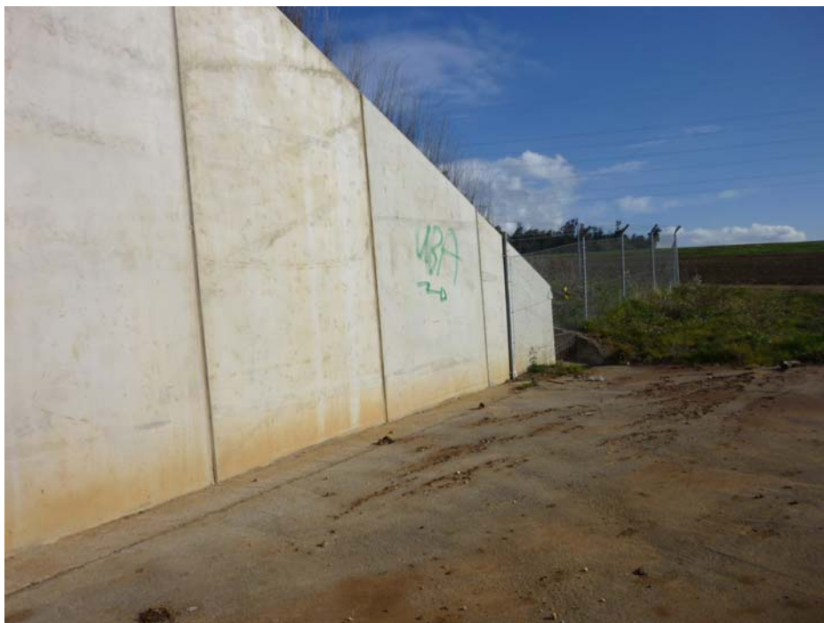
FOTOGRAFIA N° 12: Pintadas en la aleta derecha del estribo de salida
