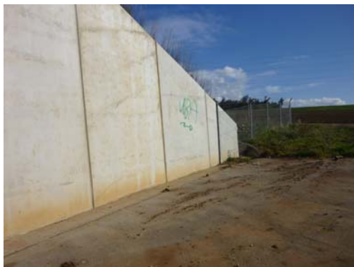
Fotografía nº 9. Pintadas en la aleta derecha del estribo de salida.
