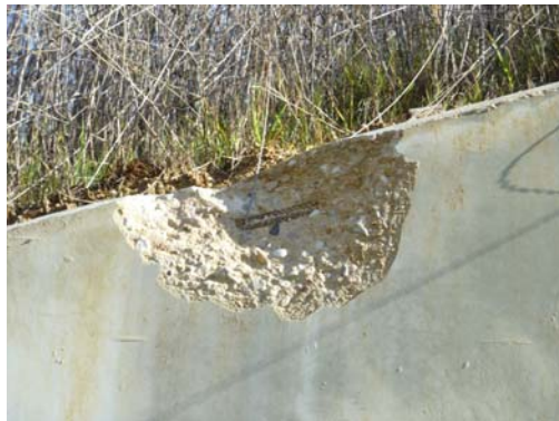
Fotografía nº 7. Desconchón con armadura expuesta en la aleta izquierda E-2.
