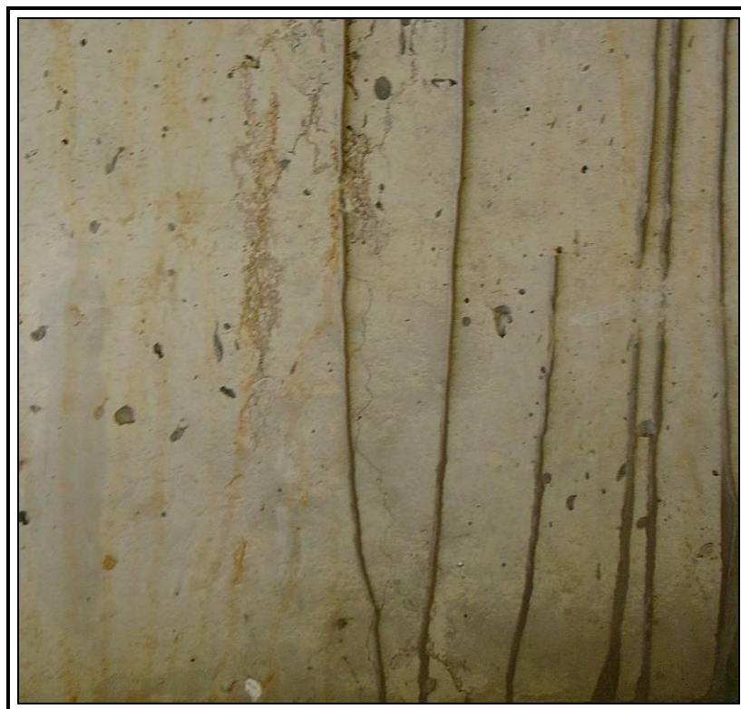
Fisura de retracción en muro frontal estribo 1.
