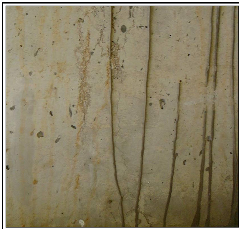
Fisura de retracción en muro frontal estribo 1.
