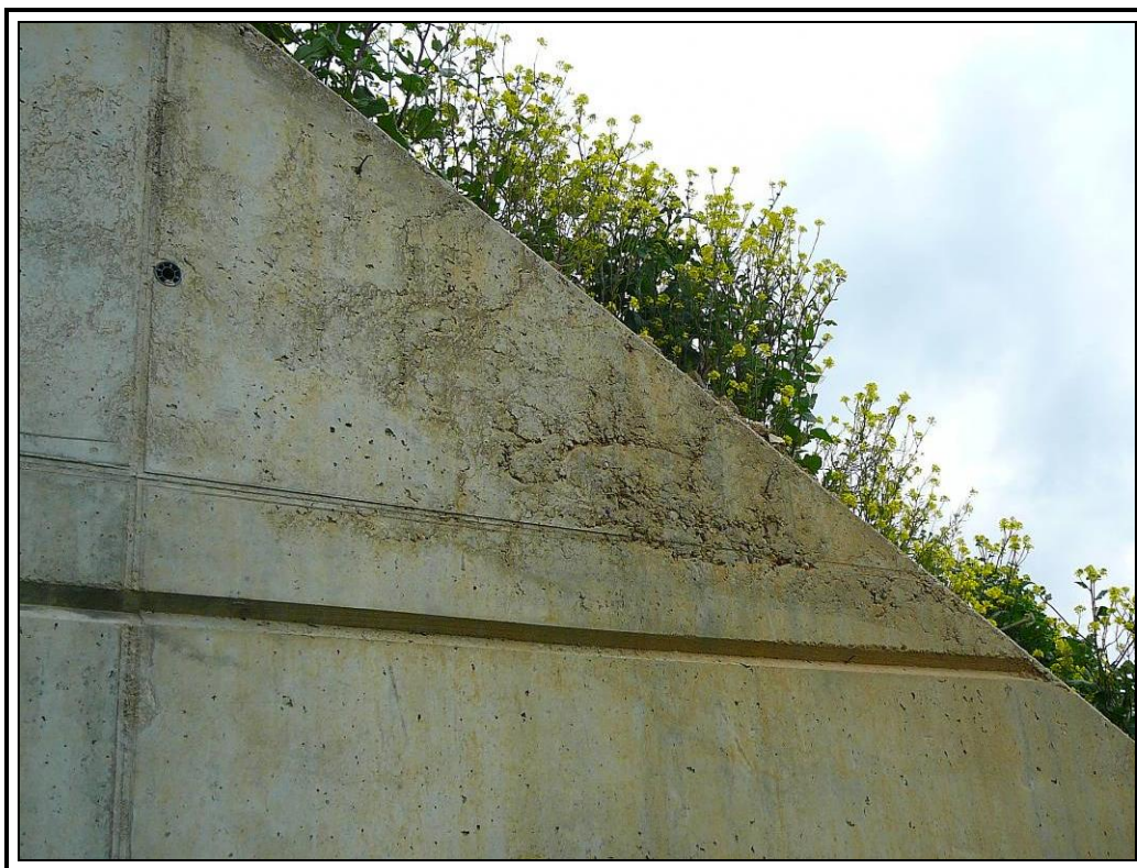
Nido de graba en aleta derecha estribo 2.
