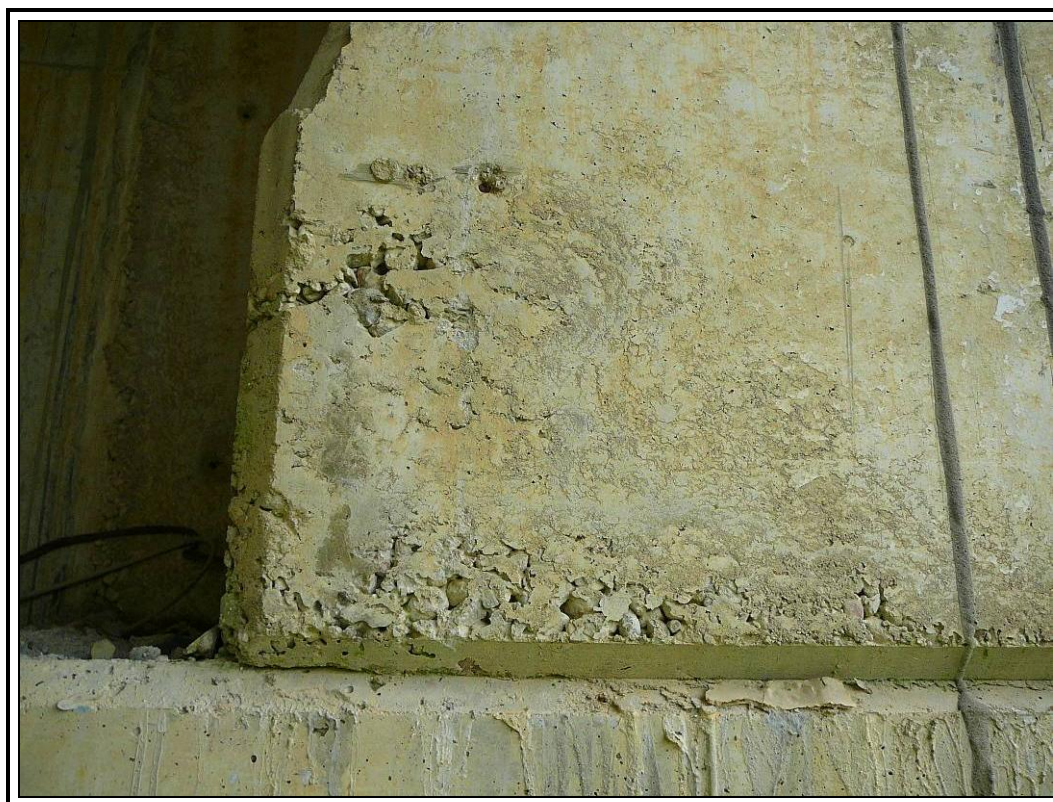
Nido de grava en oreja estribo dos.
