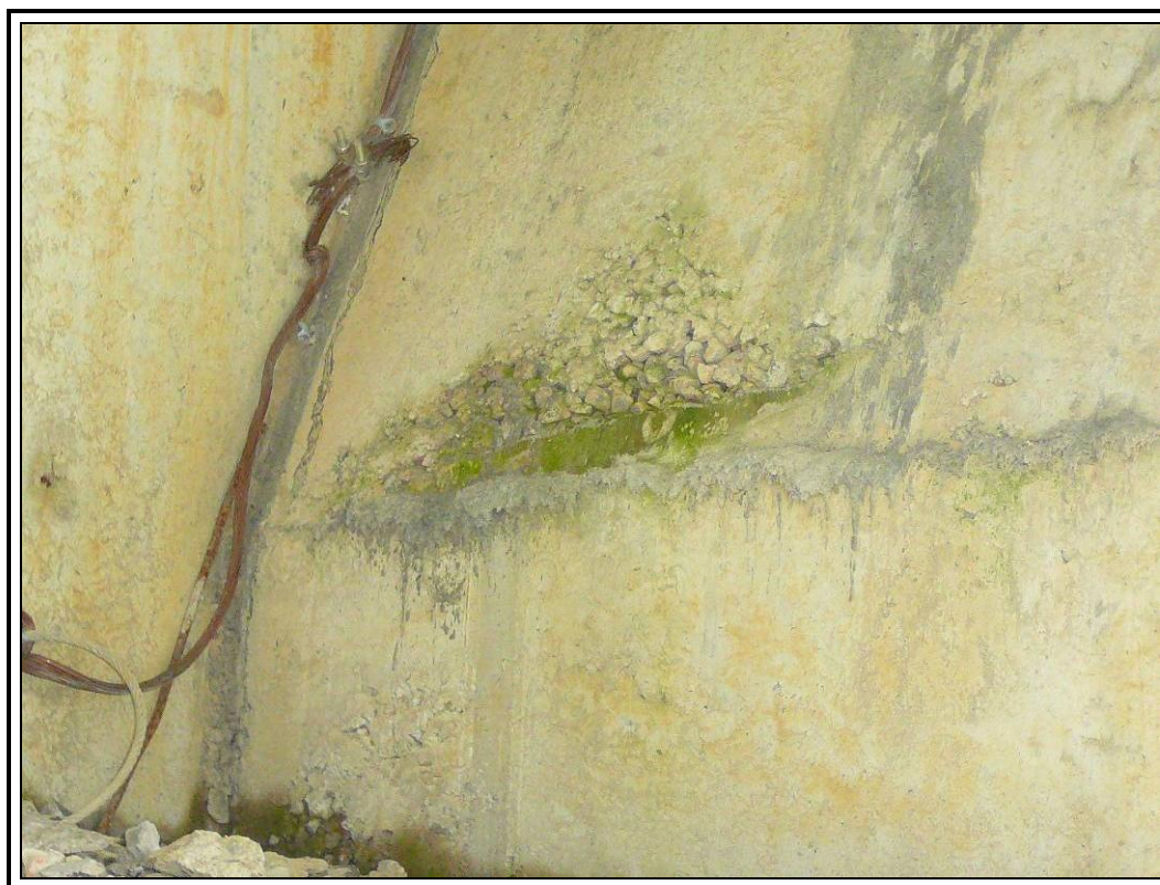
Nido de grava en oreja de estribo 2.
