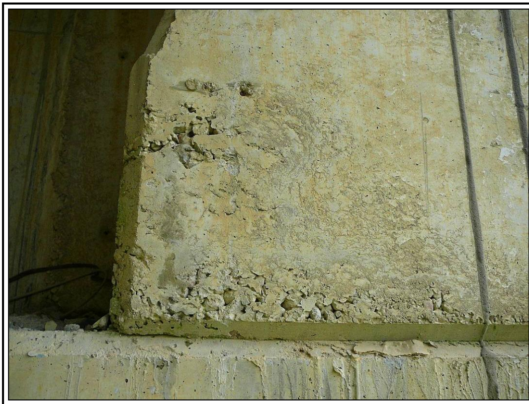
Nido de grava en oreja estribo dos.
