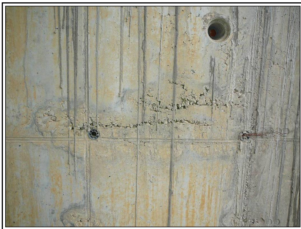
Nido de grava en estribo dos.
