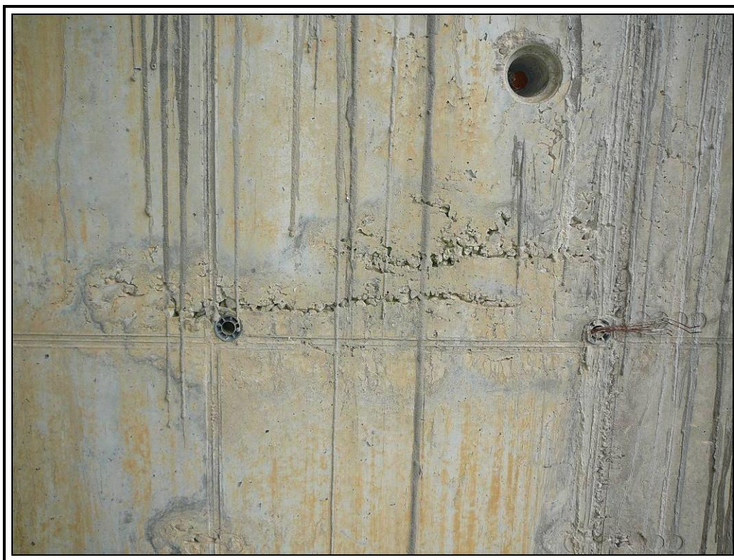
Nido de grava en estribo dos.
