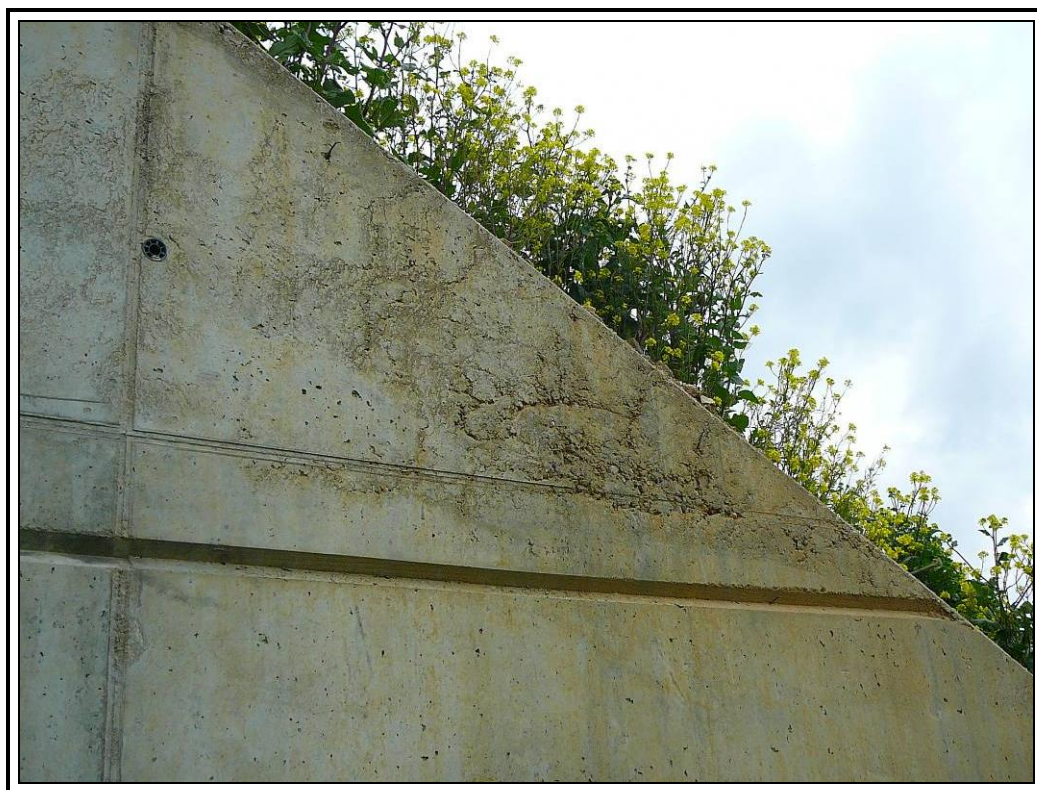
Nido de graba en aleta derecha estribo 2.
