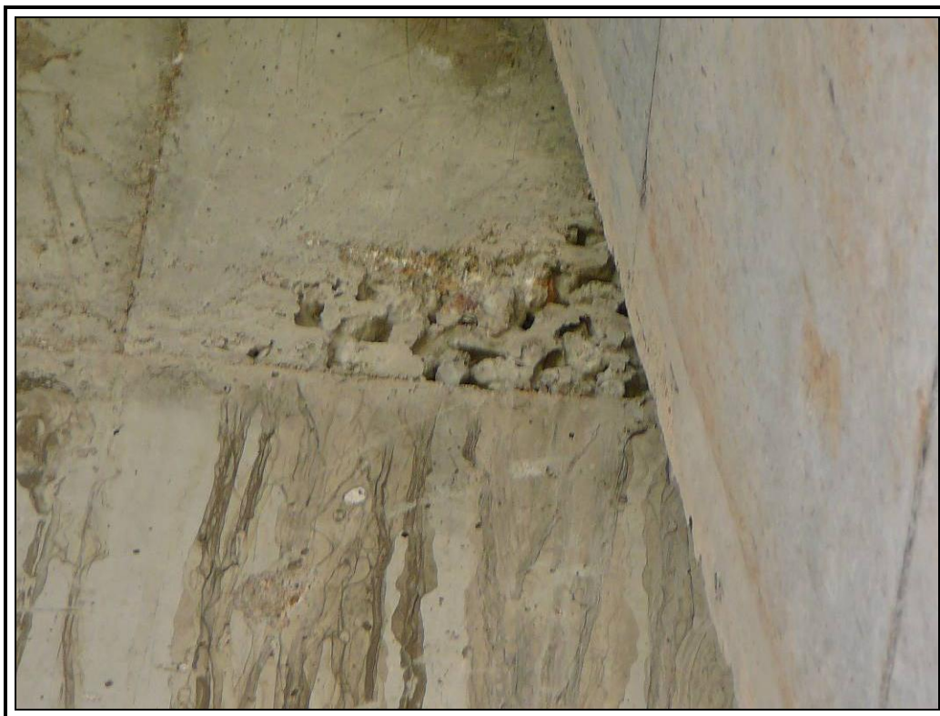
Nido de graba en murete de guarda de estribo
