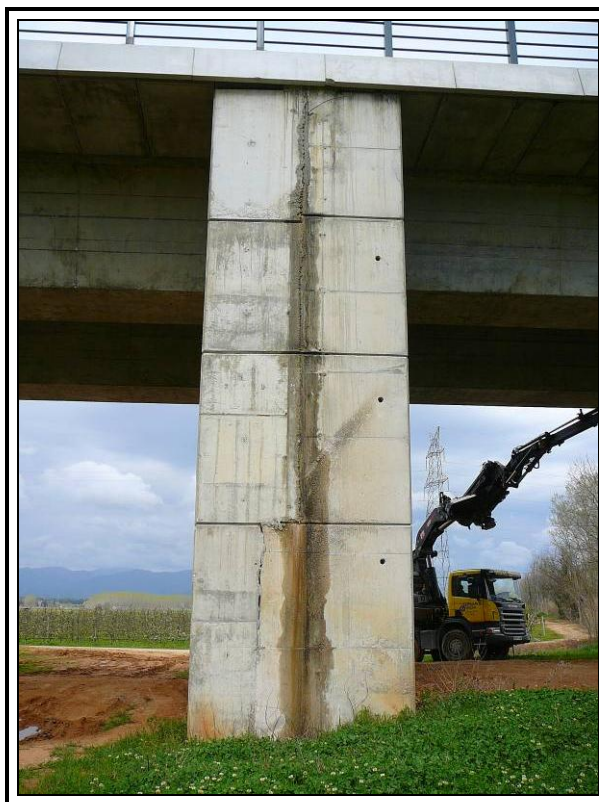
Filtraciones en junta de hormigonado en estribo 1.
