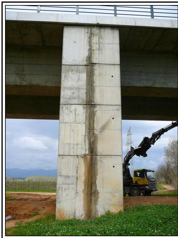
Filtraciones en junta de hormigonado en estribo 1.
