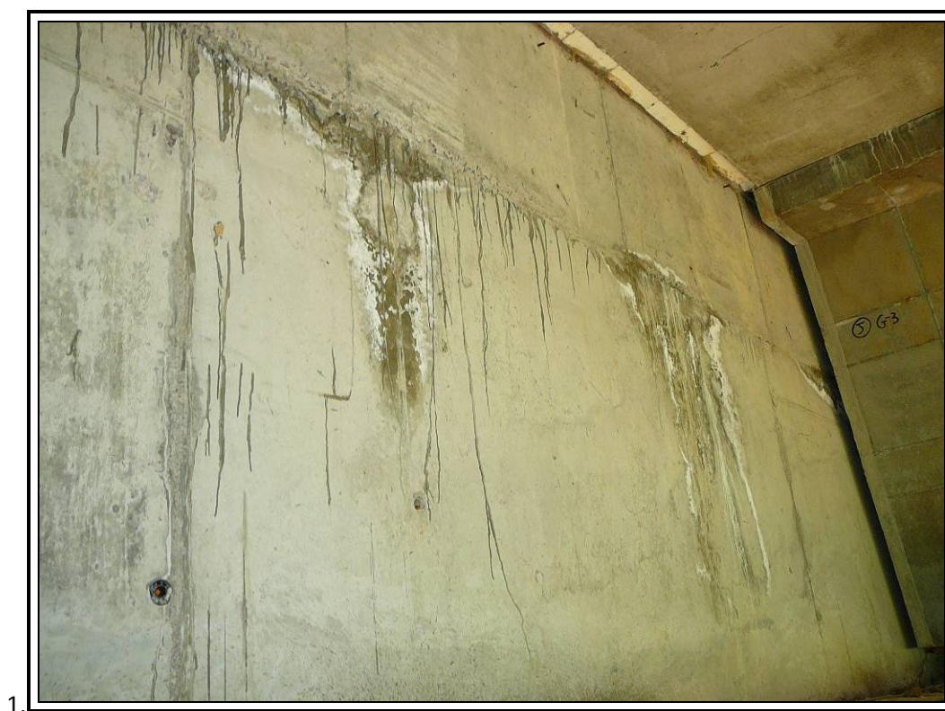
Filtraciones en murete de guarda de estribo 2.
