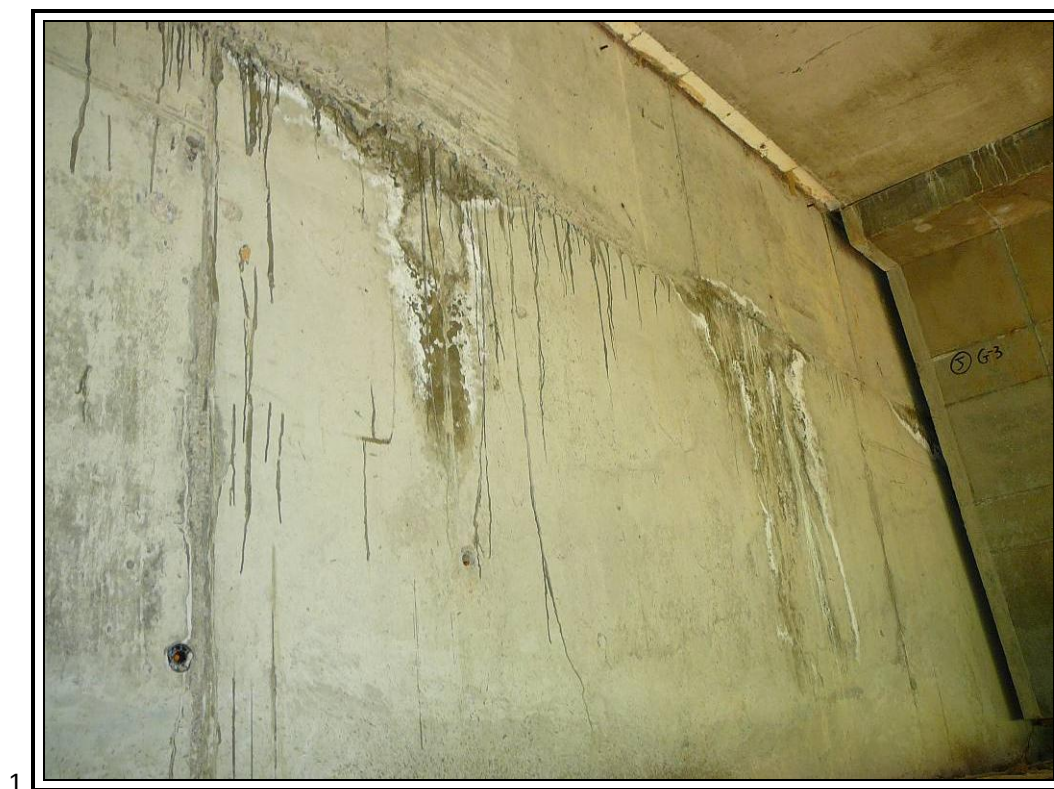
Filtraciones en murete de guarda de estribo 2.
