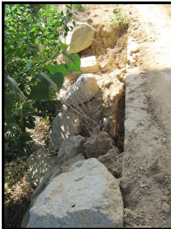
16. Deterioro en la escollera de protección del estribo de salida.
