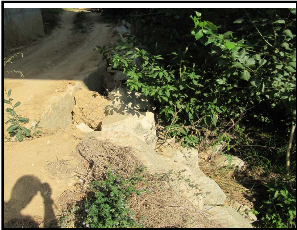
15. Deterioro en la escollera de protección del estribo de salida.
