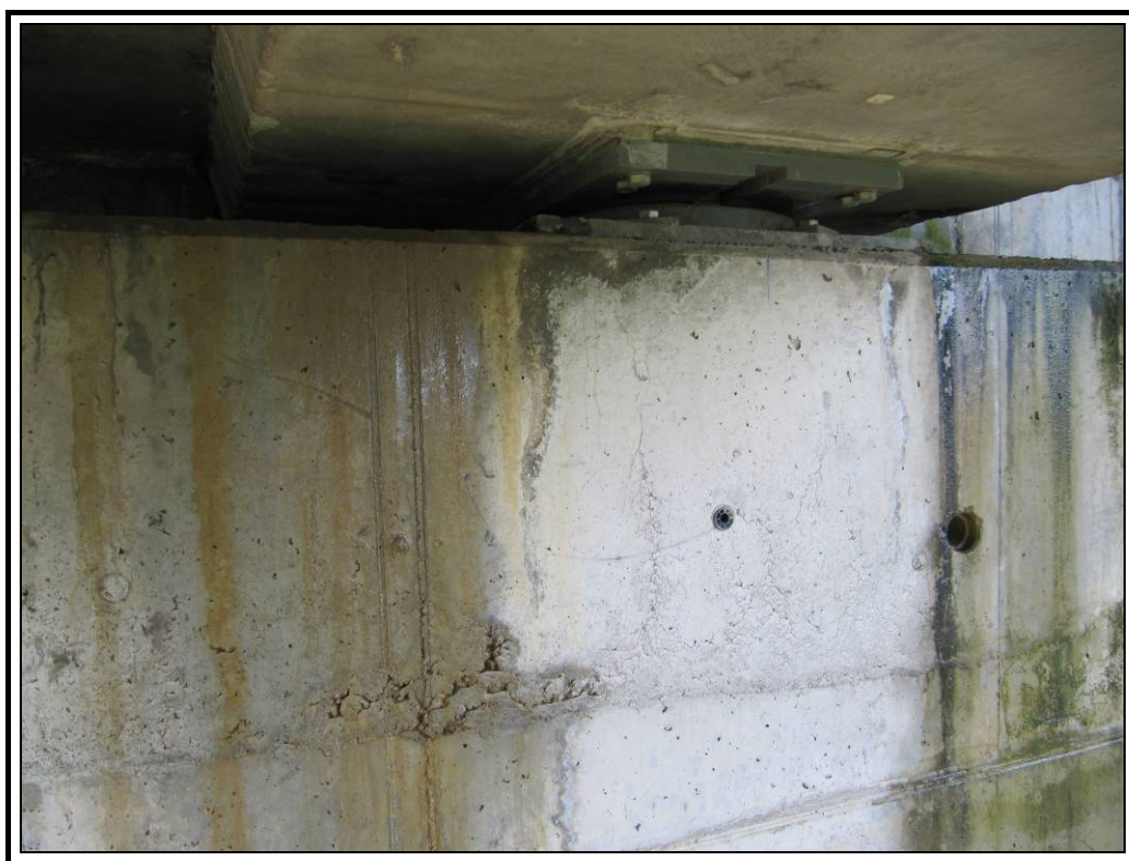
Detalle del deterioro anterior
