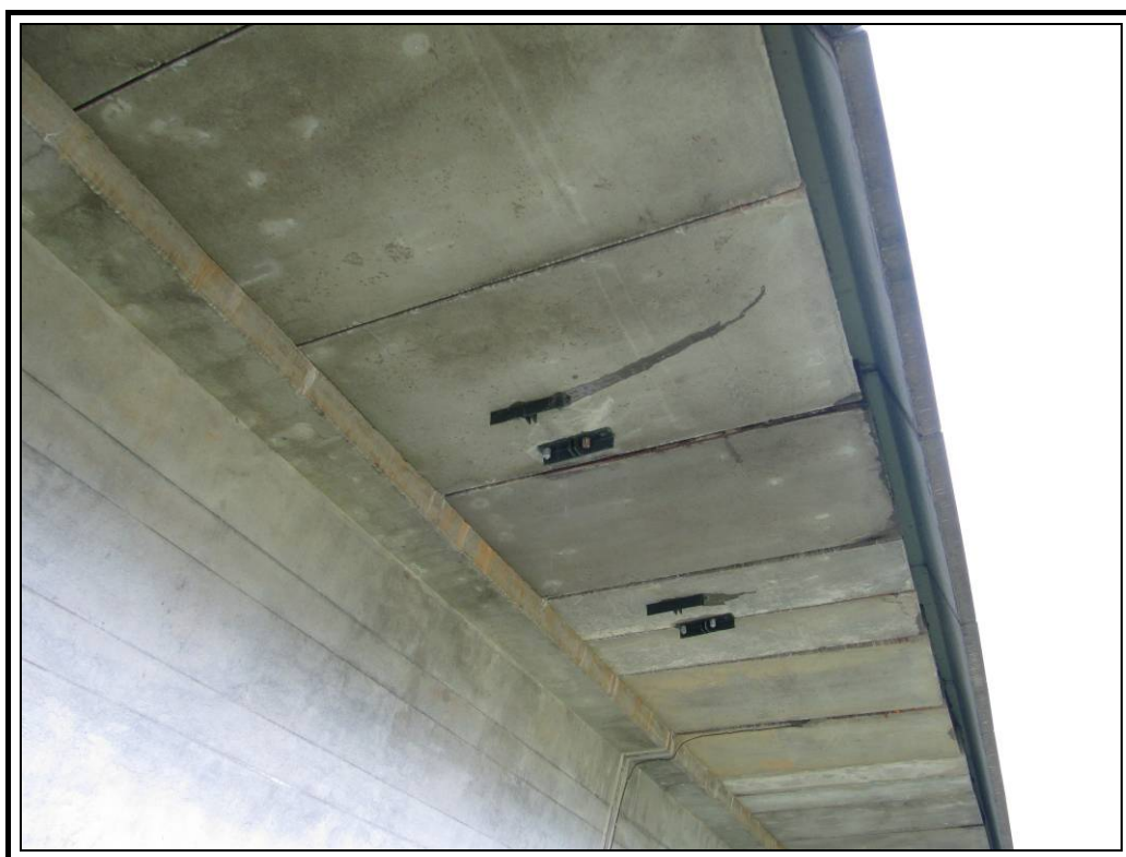
Filtraciones a través de los taladros para los soportes de los postes de la catenaria
