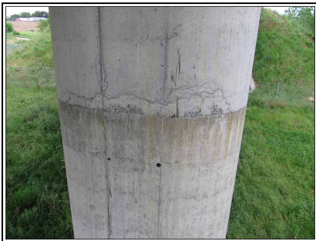
Nidos de grava en fuste izquierdo de la pila dos
