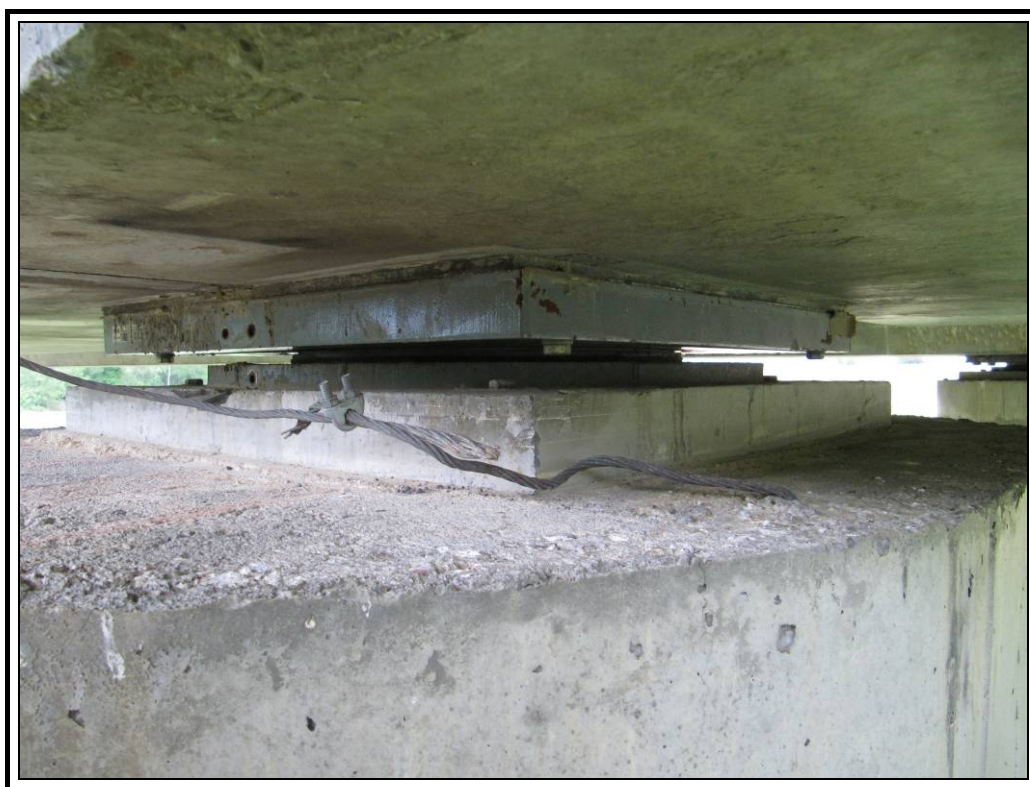
Apoyo izquierdo de pila uno
