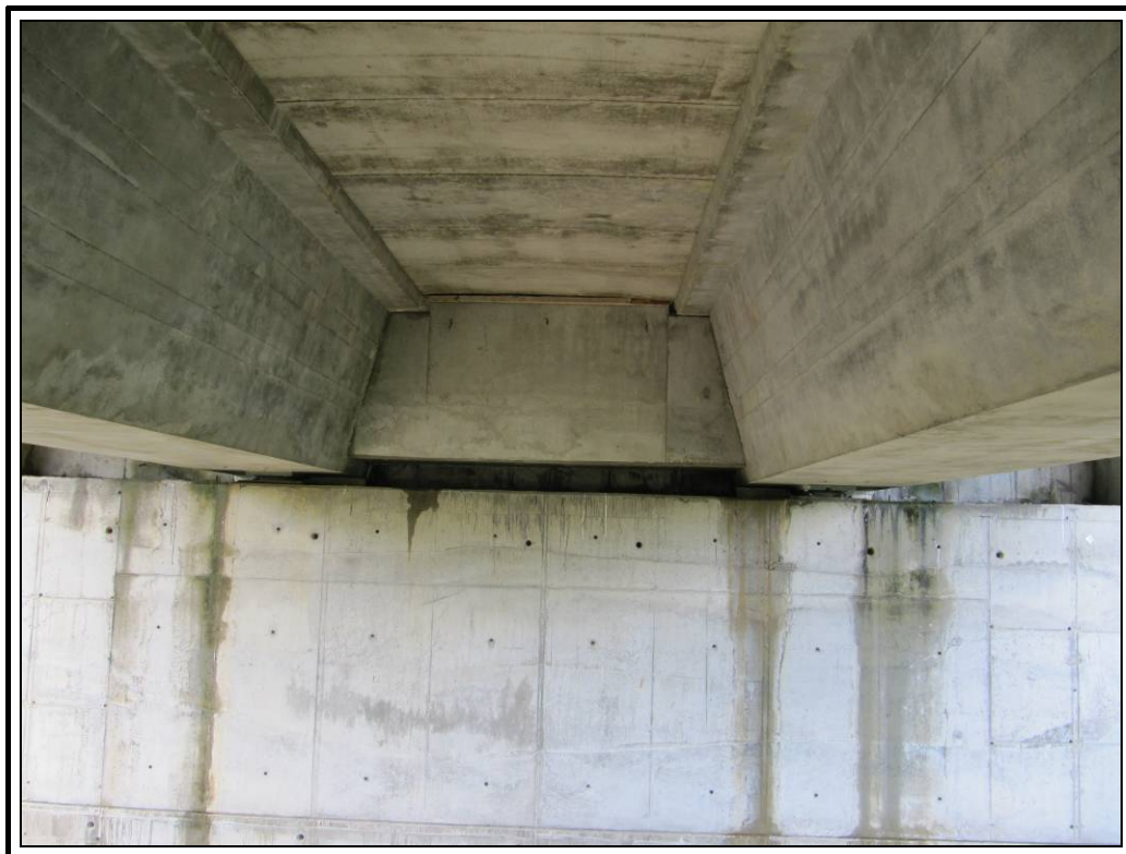
Nidos de grava en muro frontal de estribo dos
