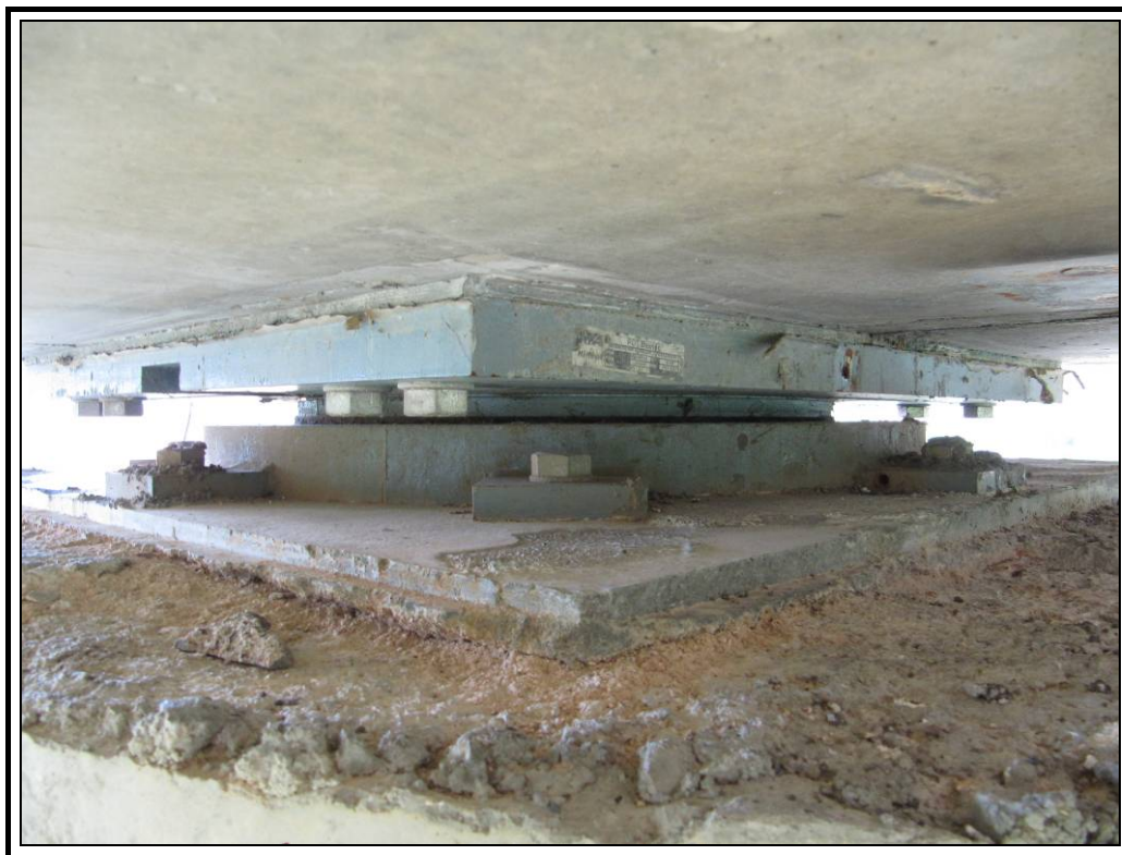
Apoyo derecho pila cuatro
