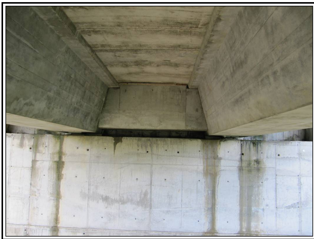
Nidos de grava en muro frontal de estribo dos
