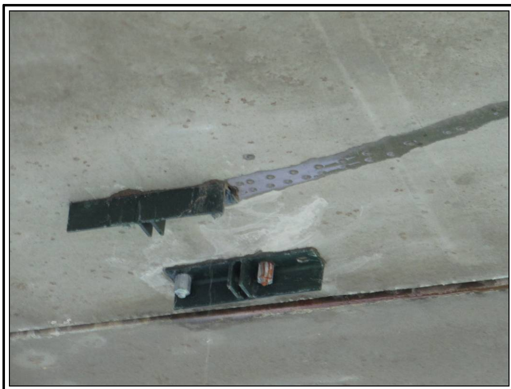
Detalle del deterioro anterior
