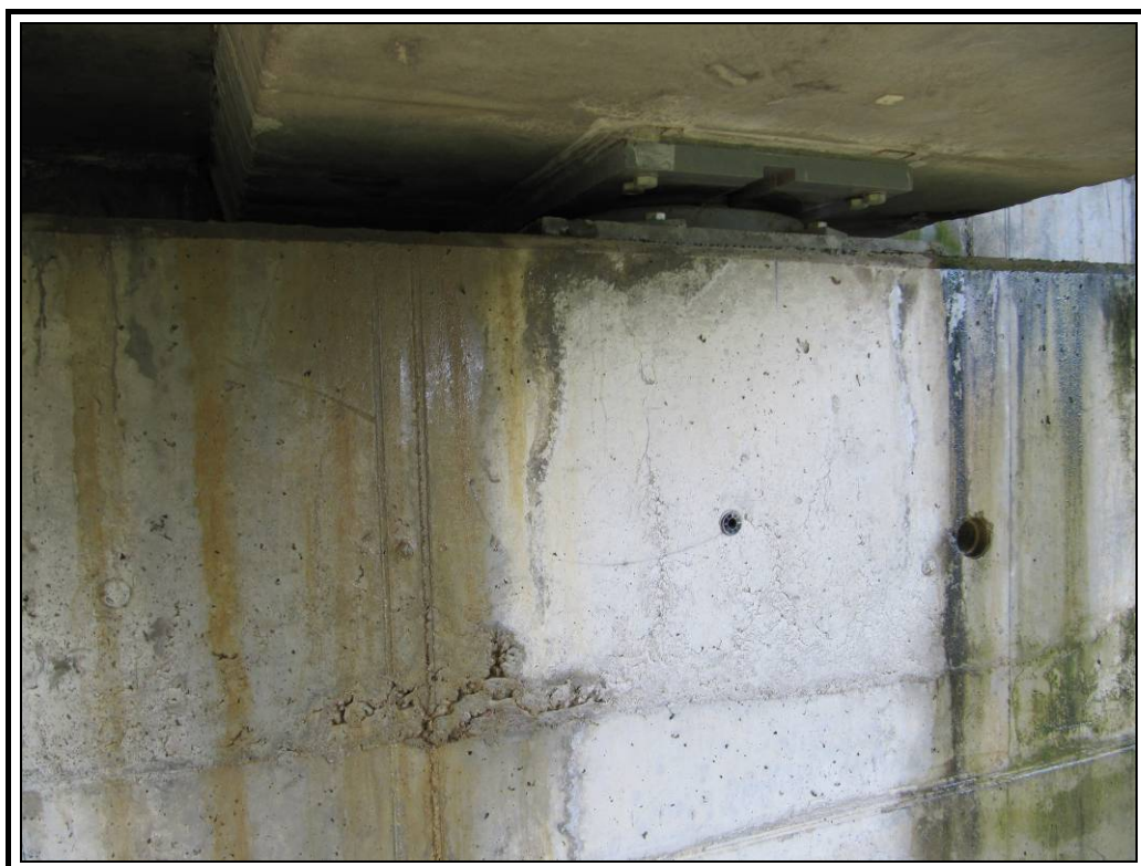
Detalle del deterioro anterior
