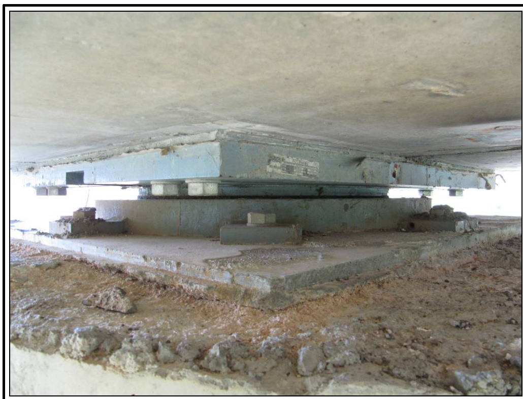
Apoyo derecho pila cuatro
