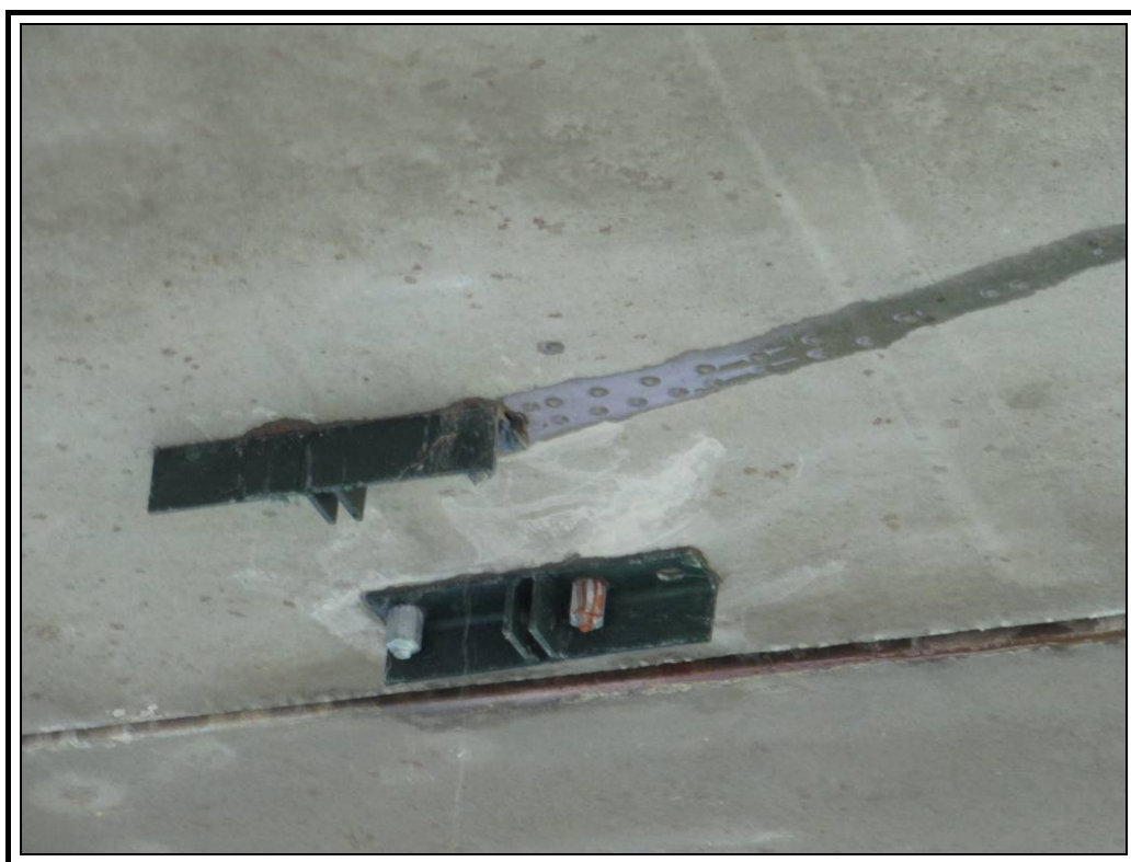
Detalle del deterioro anterior
