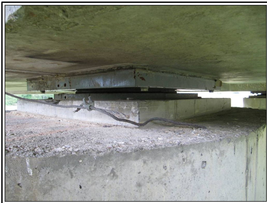
Apoyo izquierdo de pila uno
