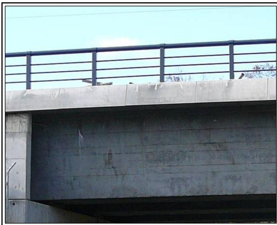
Fisura con eflorescencia en viga 1.
