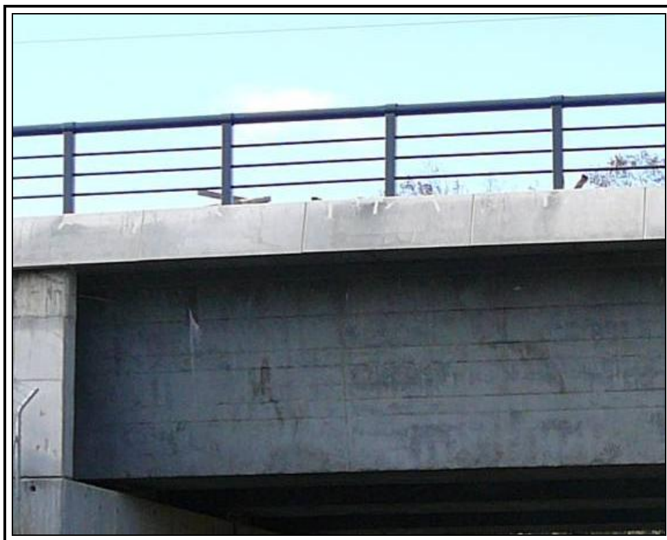
Fisura con eflorescencia en viga 1.
