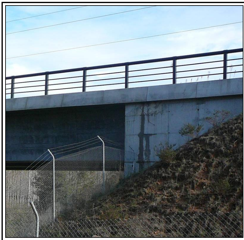
Filtraciones en muros en vuelta de estribo 1
