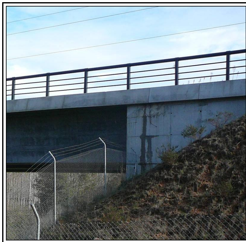
Filtraciones en muros en vuelta de estribo 1
