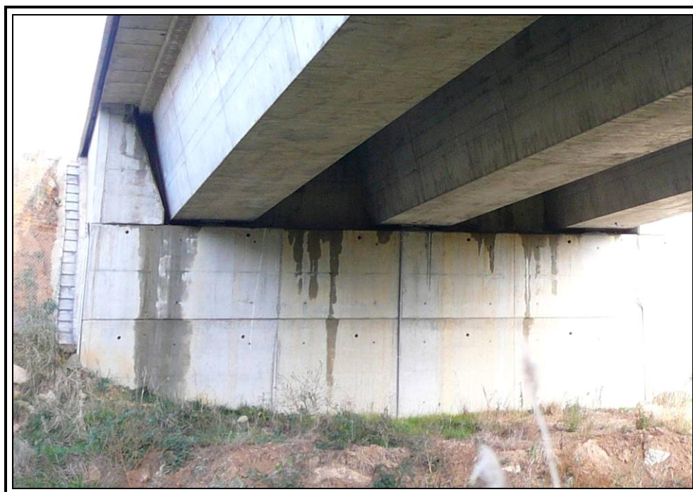
Filtraciones en muro frontal de estribo 2
