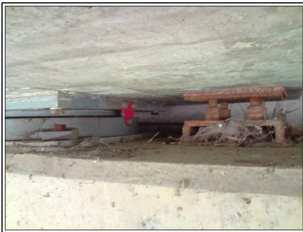
Elementos de sujeción no retirados.
