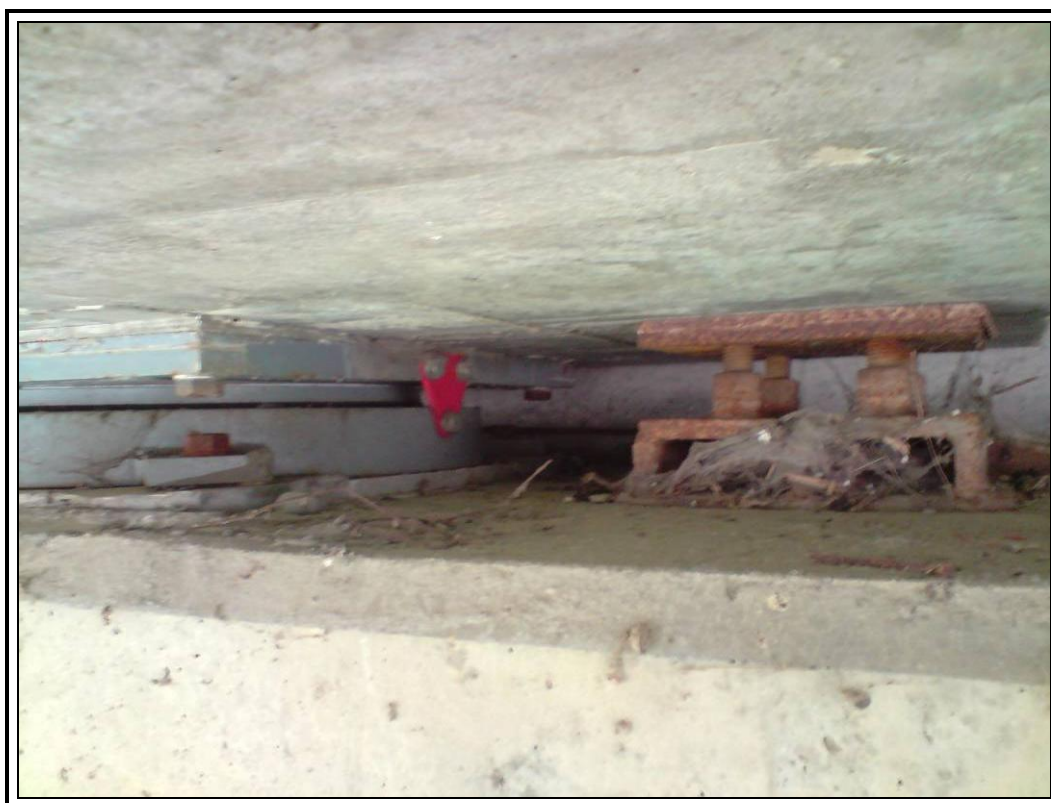
Elementos de sujeción no retirados.
