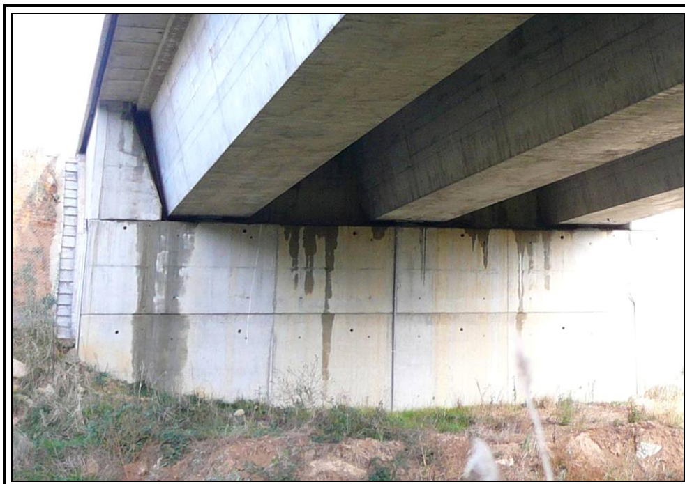
Filtraciones en muro frontal de estribo 2
