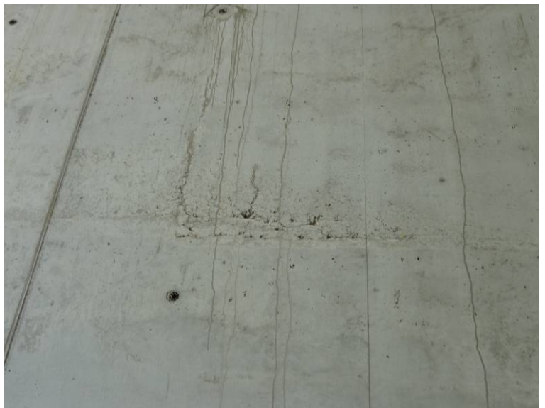
Fotografía N°12: Coqueras y nidos de grava en estribo.
