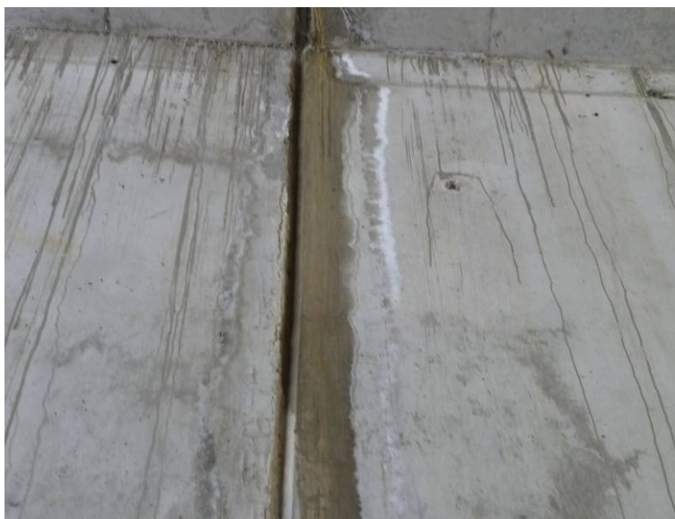
Fotografía N°13: Humedades y eflorescencias en estribo.
