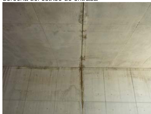
Fotografía nº 10. Eflorescencias en el paramento inferior de la losa superior y en el hastial de entrada
