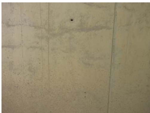
Fotografía nº 7. Fisuras verticales en el hastial del estribo de entrada
