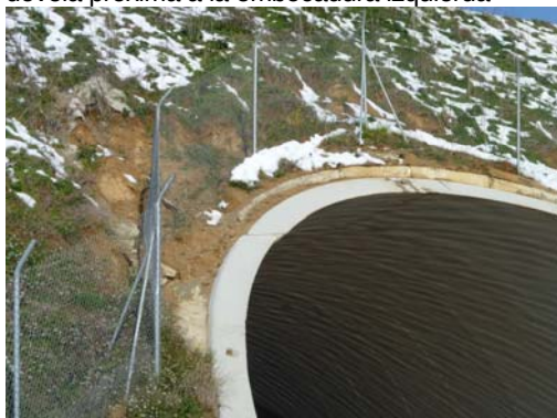
Fotografía nº 9. Erosión del terraplén de la embocadura derecha
