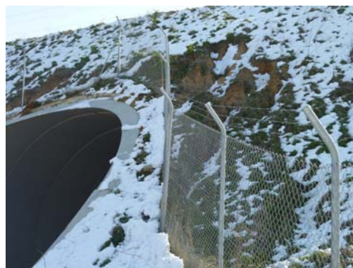
Fotografía nº 8. Erosión del terraplén de la embocadura izquierda
