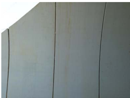
Fotografía nº 7. Fisuras por retracción en una dovela próxima a la embocadura izquierda
