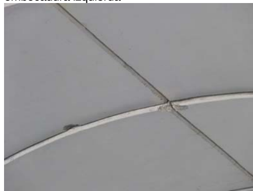
Fotografía nº 10. Desconchones en algunas dovelas
