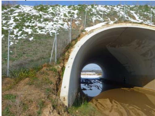
Fotografía nº 9. Erosión del terraplén de la embocadura derecha
