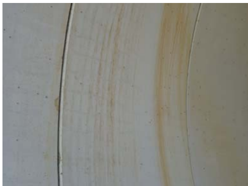
Fotografía nº 7. Fisuras por retracción en una dovela próxima a la embocadura derecha
