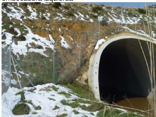
Fotografía nº 9. Erosión del terraplén de la embocadura derecha
