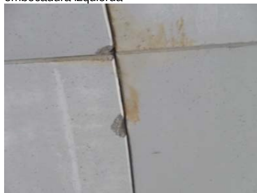
Fotografía nº 10. Desconchones en algunas dovelas
