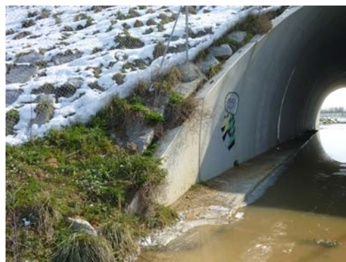
Fotografía nº 8. Pintadas en una aleta de la embocadura izquierda
