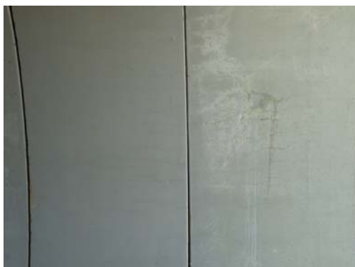
Fotografía nº 7. Fisuras por retracción en la embocadura izquierda
