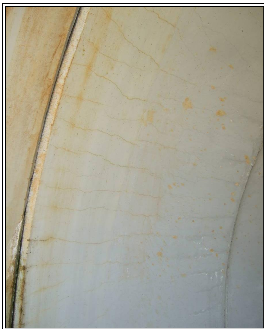
Familia de fisuras en elemento de estribo 1 lado derecho.
