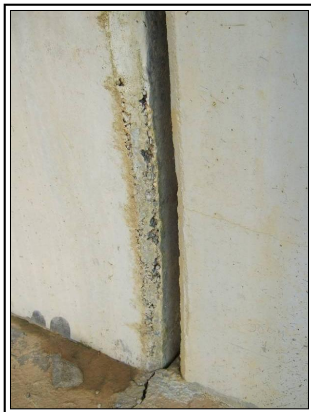
Nido de grava en elemento estribo 1 lado izquierdo.
