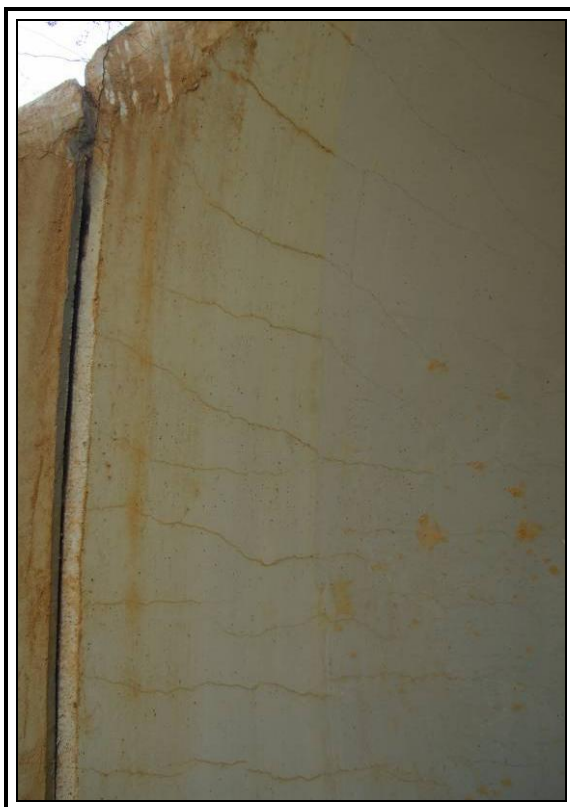
Familia de fisuras en elemento de estribo 1 lado derecho.
