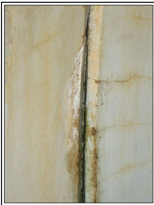
Filtraciones con eflorescencias entre elementos desplazados del estribo derecho lado derecho.
