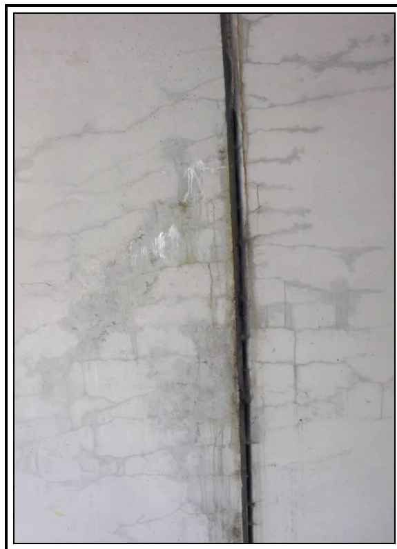
Familia de fisuras en piel de cocodrilo en elemento de estribo 1 lado derecho.
