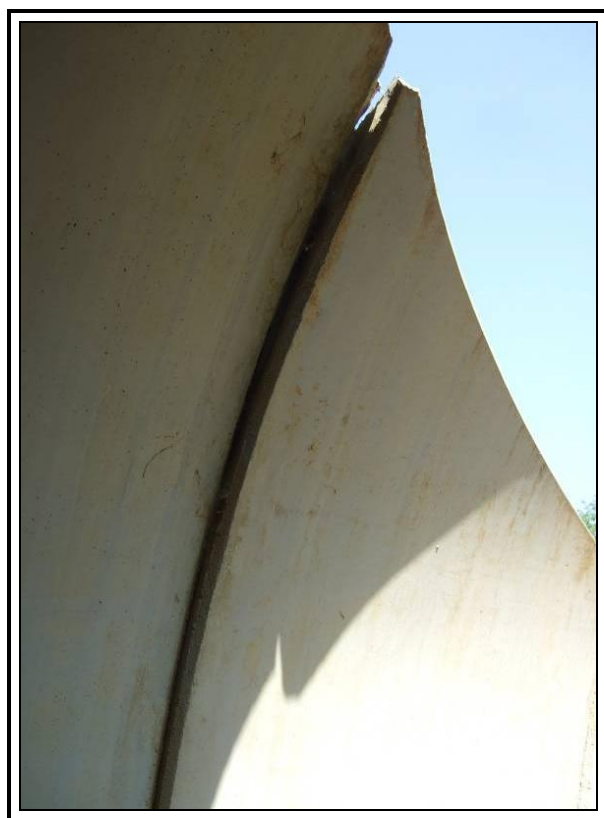
Desplazamiento entre elementos estribo 2 lado derecho.
