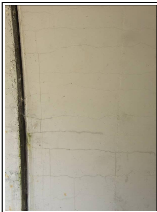
Fisuras en dovelas.
