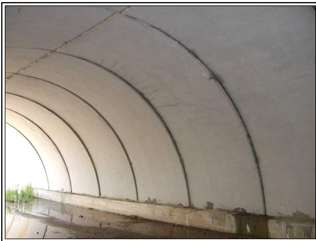
Desplazamiento entre elementos en estribo 1 lado derecho.
