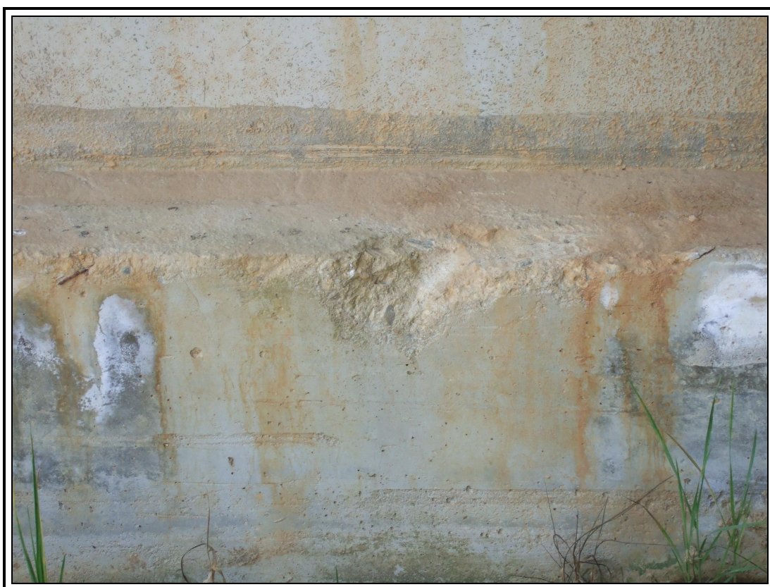
Desconchón por golpe en estribo 1.
