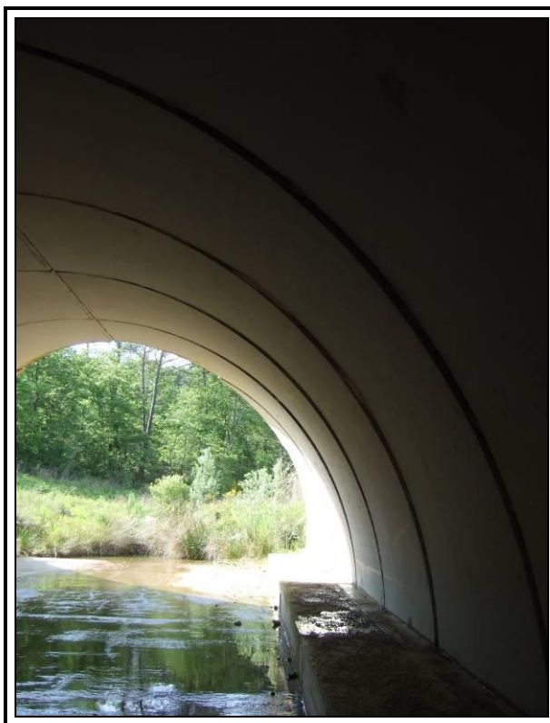
Desplazamiento entre elementos en estribo 1 lado izquierdo.
