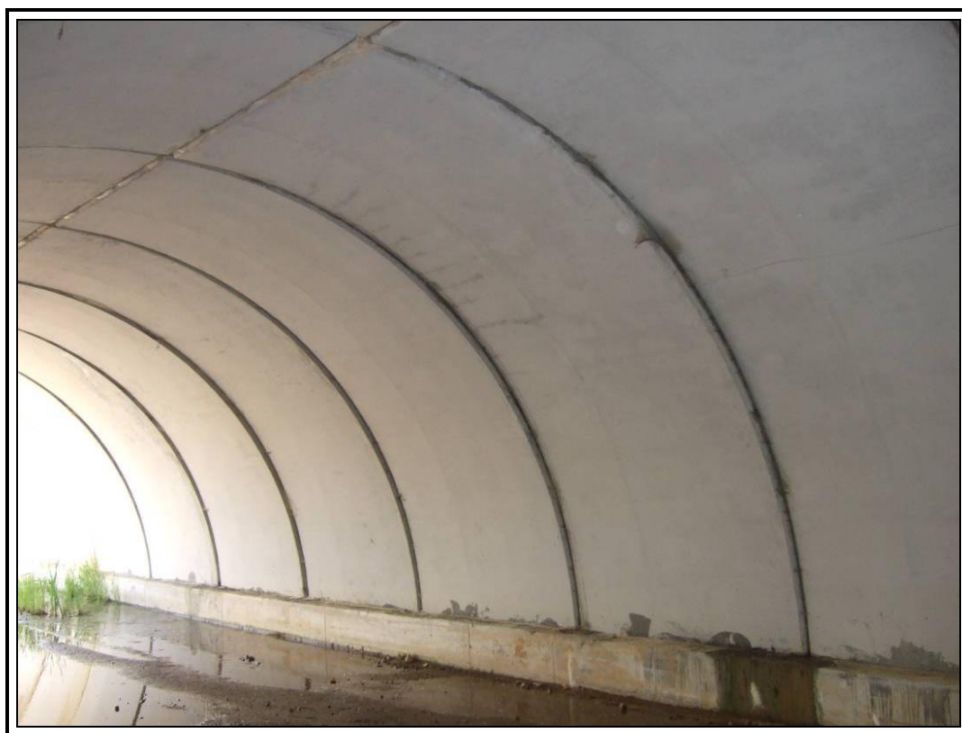
Desplazamiento entre elementos en estribo 1 lado derecho.
