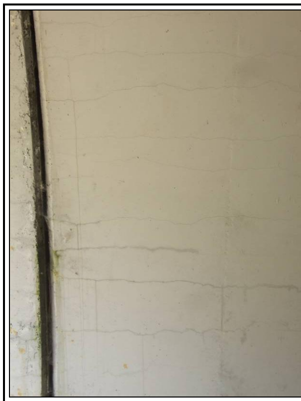
Fisuras en dovelas.
