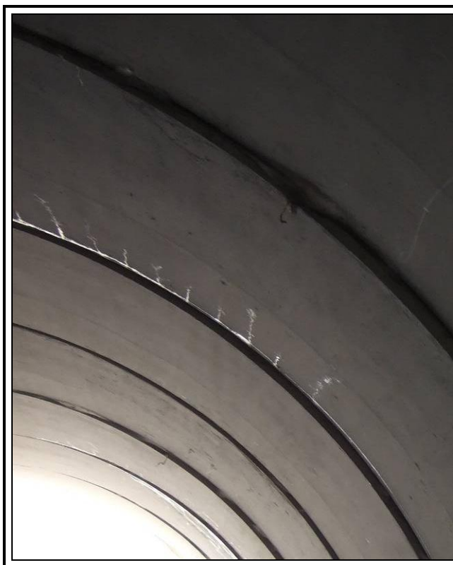
Filtraciones entre elementos desplazados.
