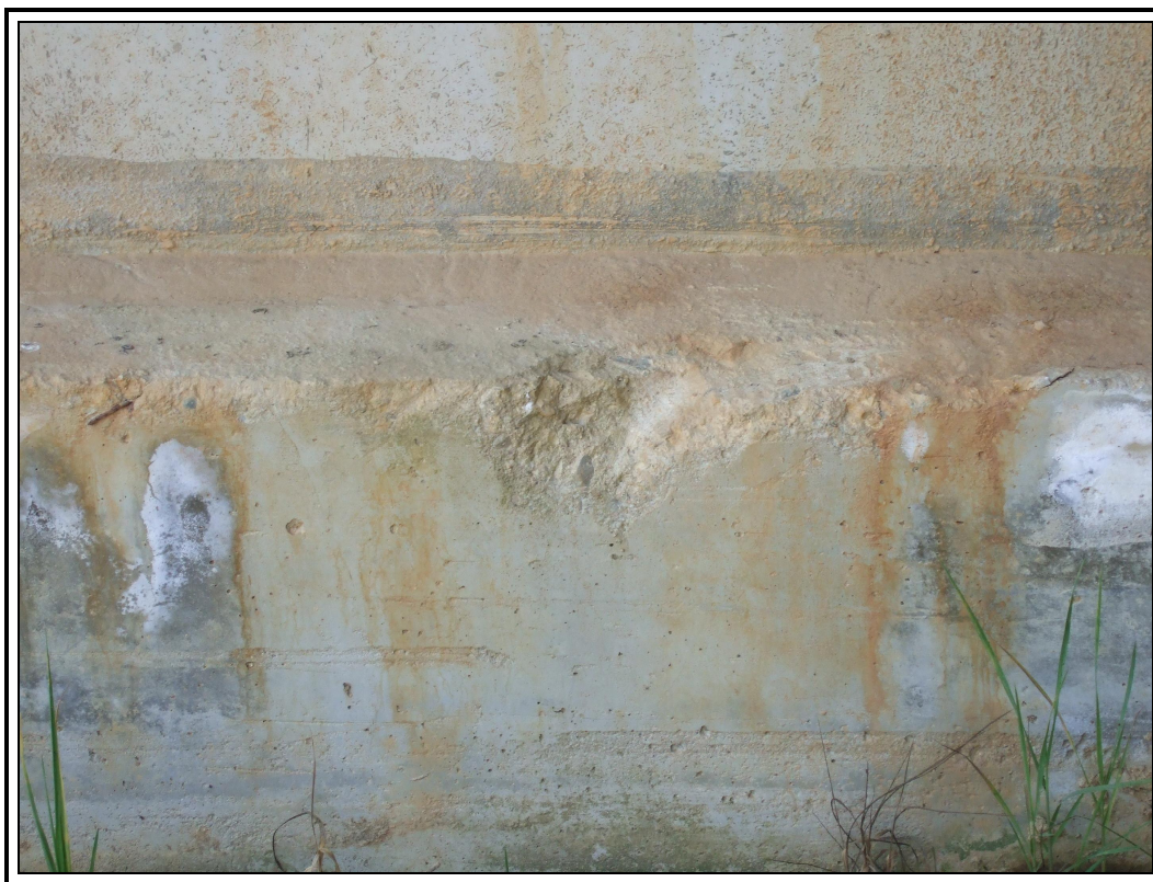
Desconchón por golpe en estribo 1.
