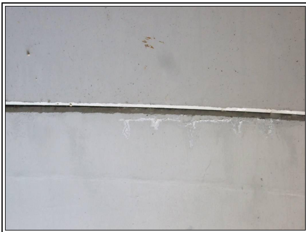
Filtraciones con eflorescencias por la junta entre anillos.
