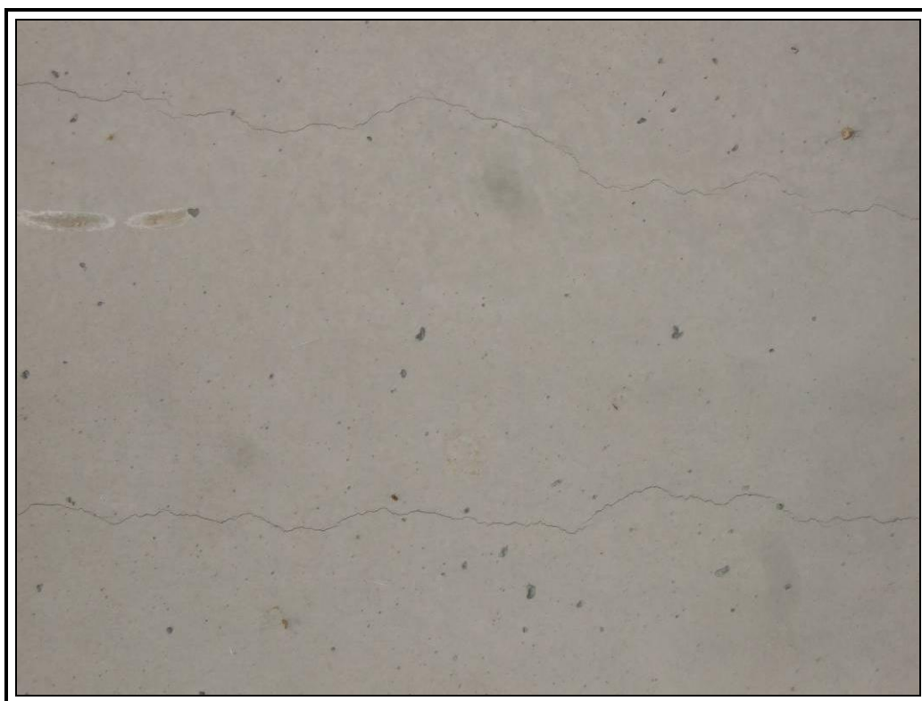
Detalle de fisuras horizontales en la bóveda
