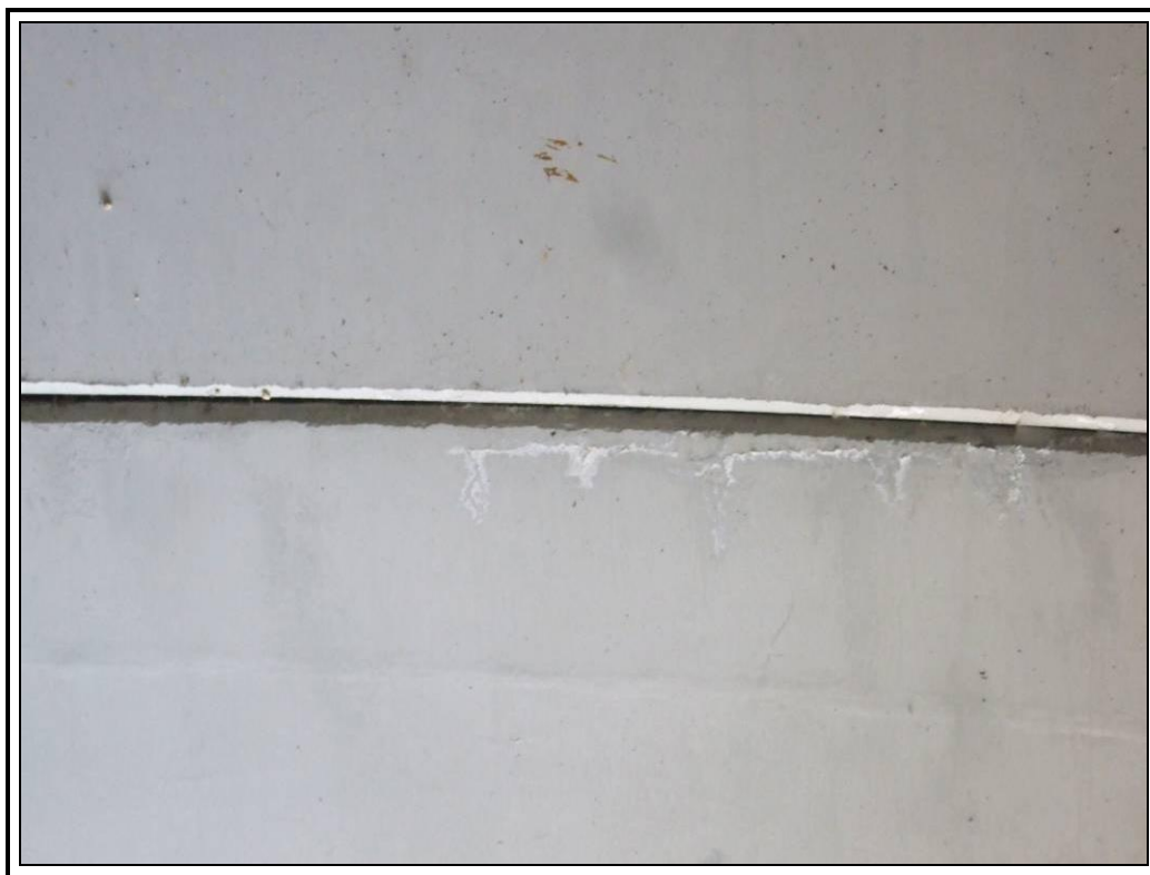
Filtraciones con eflorescencias por la junta entre anillos.
