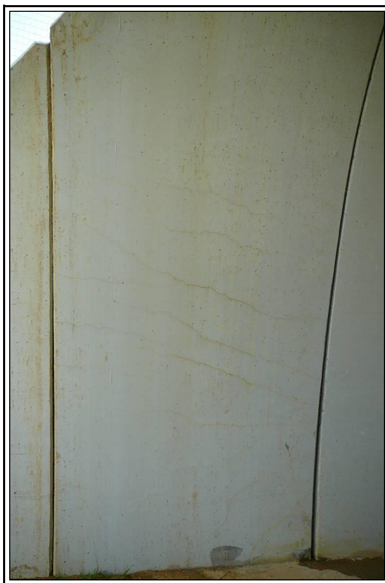
Familia de fisuras en elemento lado izquierdo.
