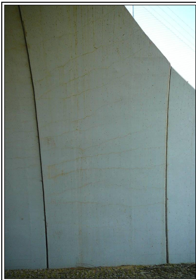
Familia de fisuras en elemento lado izquierdo.
