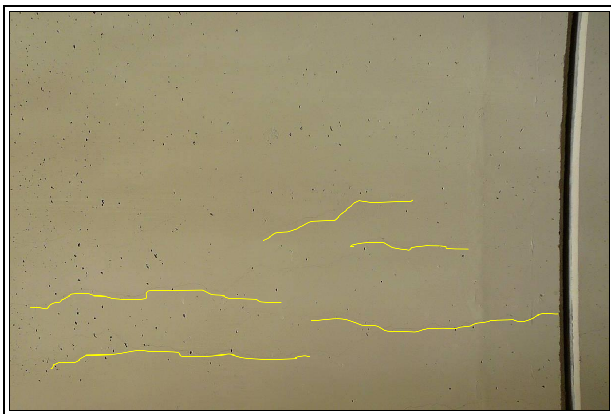
Fisuras de retracción.
