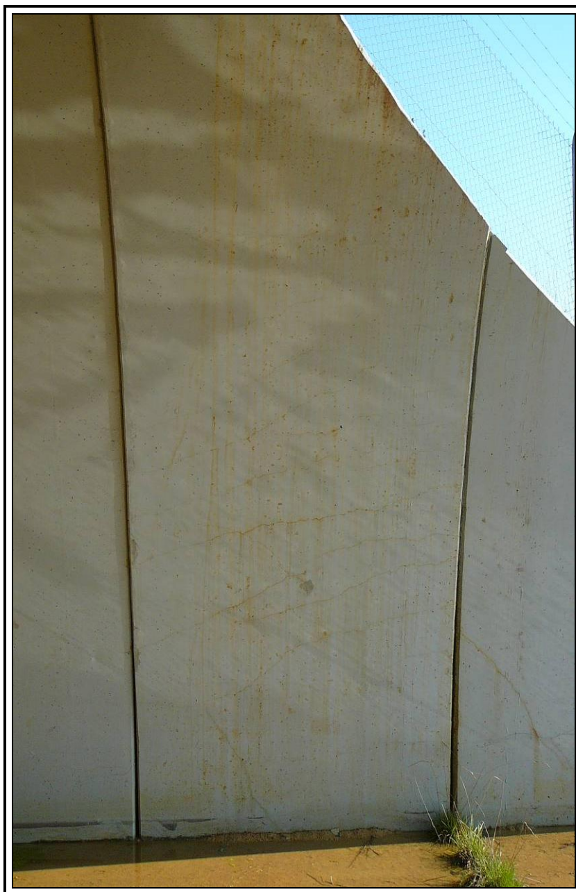
Familia de fisuras en elemento lado derecho.
