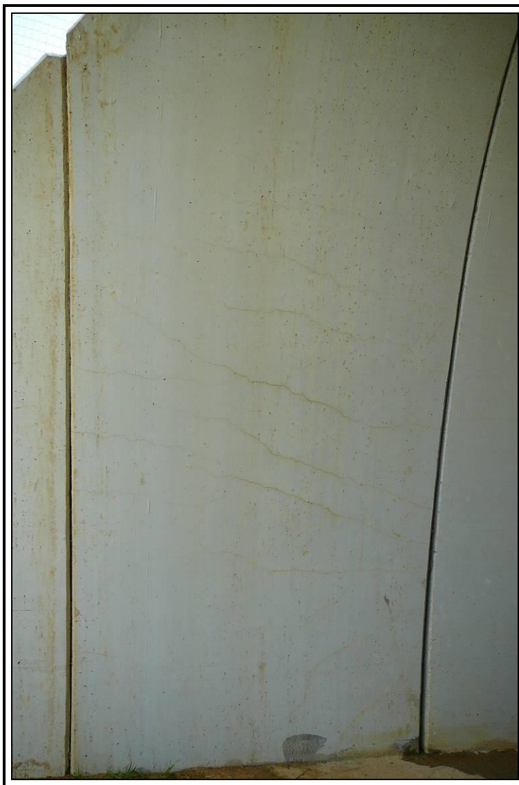
Familia de fisuras en elemento lado izquierdo.
