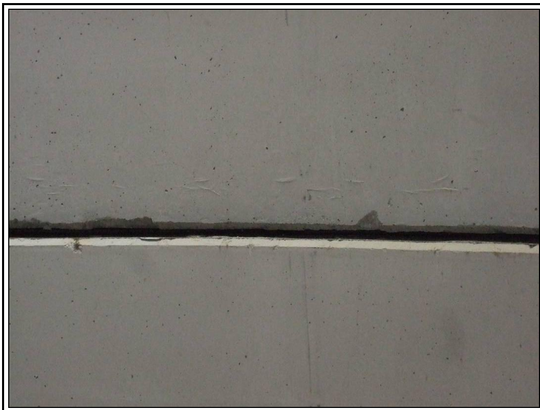
Desplazamiento entre elementos en estribo 1 lado derecho.
