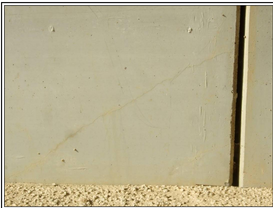
Fisuras en elemento del tercer anillo de estribo 1 lado derecho.
