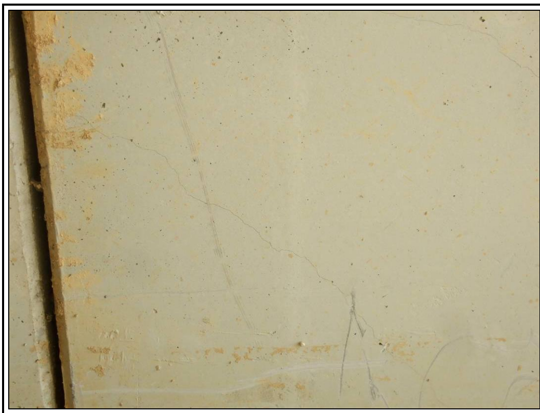
Fisuras en elemento del decimoséptimo anillo del estribo 1 lado izquierdo.
