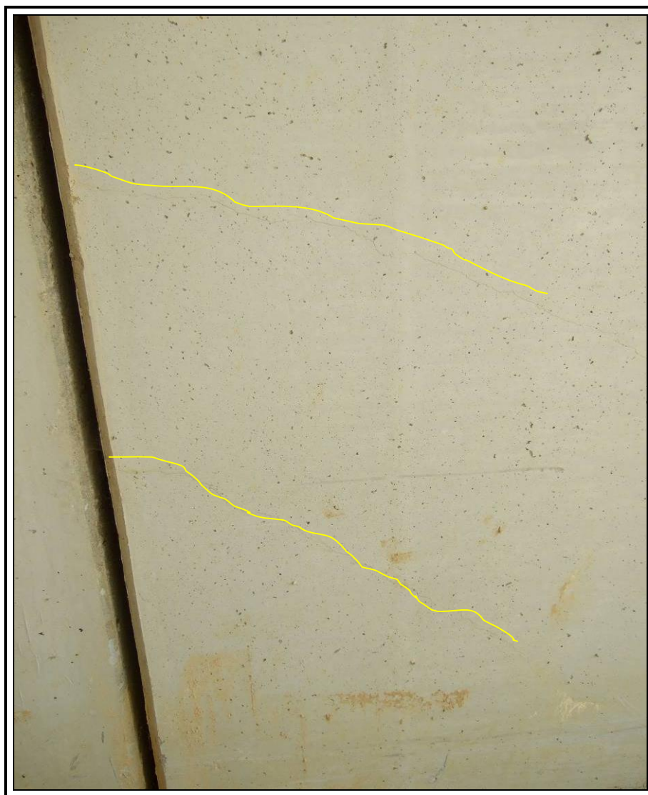
Familia de fisuras en elemento del decimoctavo anillo del estribo 1 lado izquierdo.
