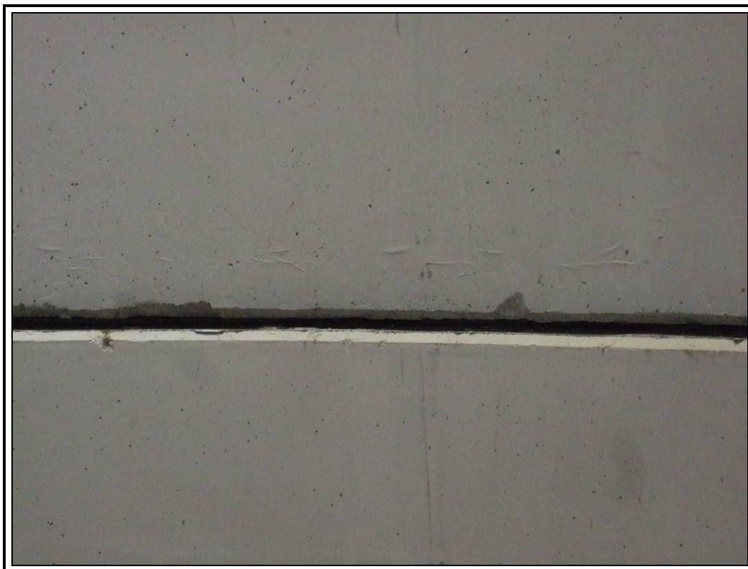
Desplazamiento entre elementos en estribo 1 lado derecho.
